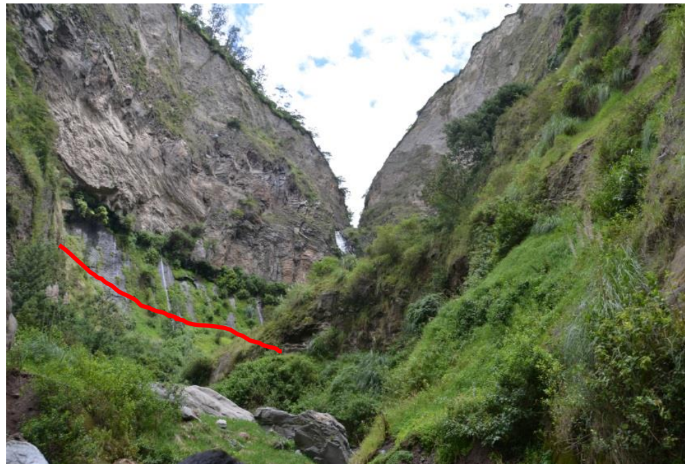
Filtración de agua subterránea
