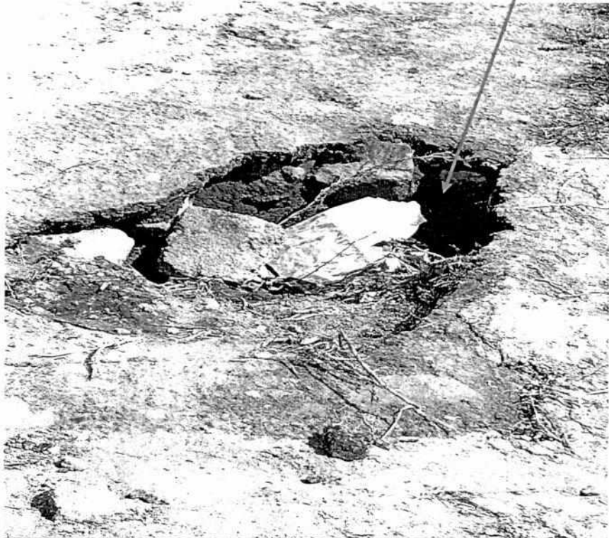
Hueco en la calzada de la calle El Chaco
