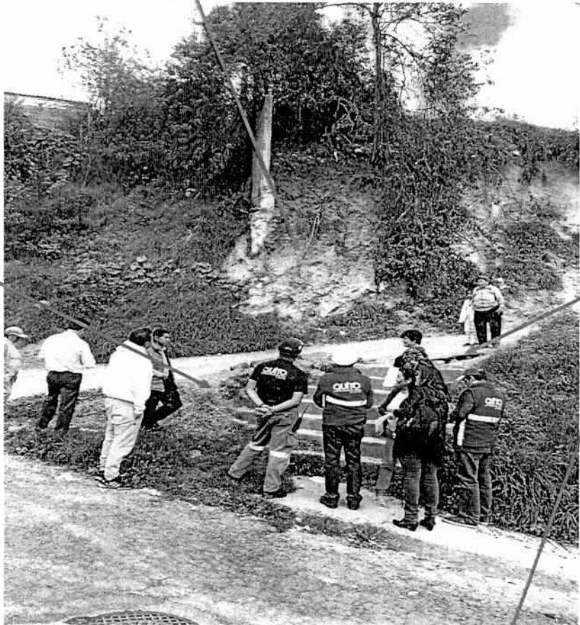
Talud inestable en la calle El Chaco
