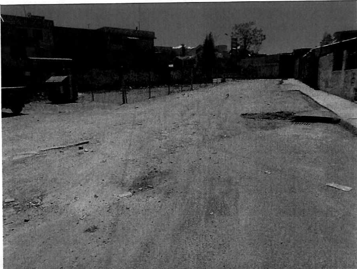
Vía en tierra, presenta hundimientos y desniveles.
