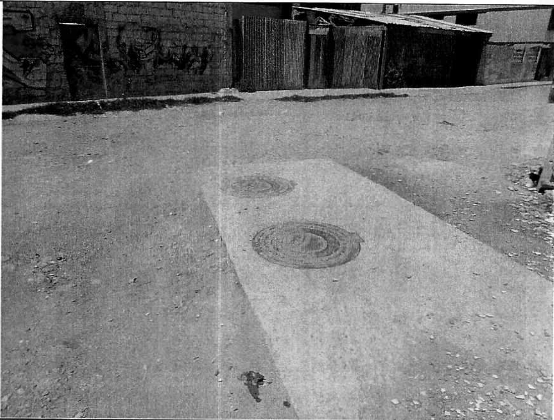
Vía en tierra, presenta hundimientos y desniveles.
