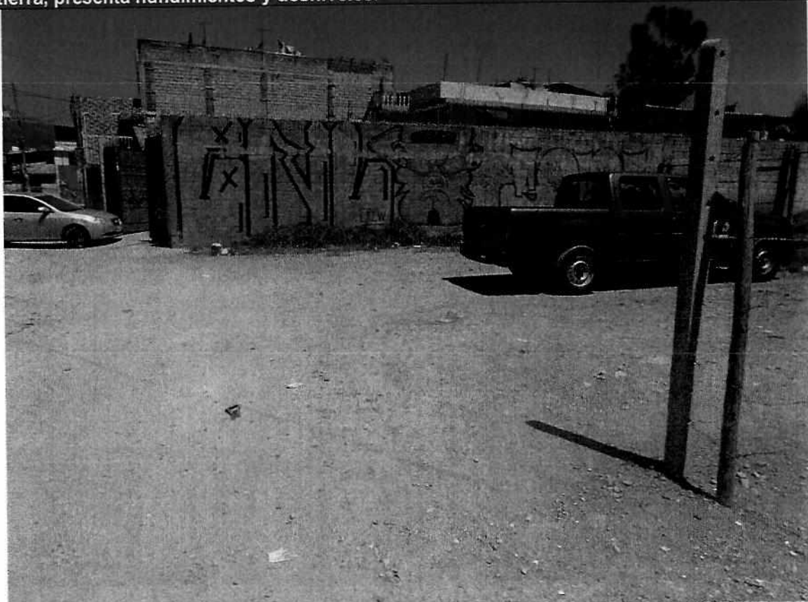
Vía en tierra, presenta hundimientos y desniveles.
