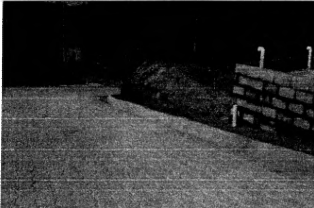
Acera faltante en acceso vehicular
