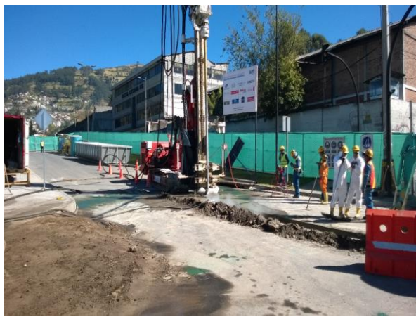
Foto 3.- 14/08/2017. Corralito Sur para la Estación La Magdalena: Perforación e inyección de taladro M302.
