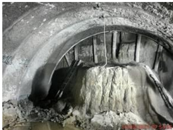
Foto 2.- 15/08/2017. Excavación a nivel de bóveda, colocación de malla electrosoldada, cerchas y hormigón lanzado
