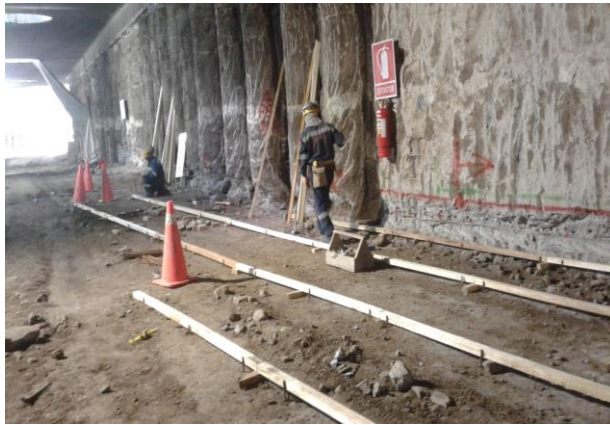
Foto 1.- Colocación de rastreles para replantillo en rampa de vaciado previo al armado
