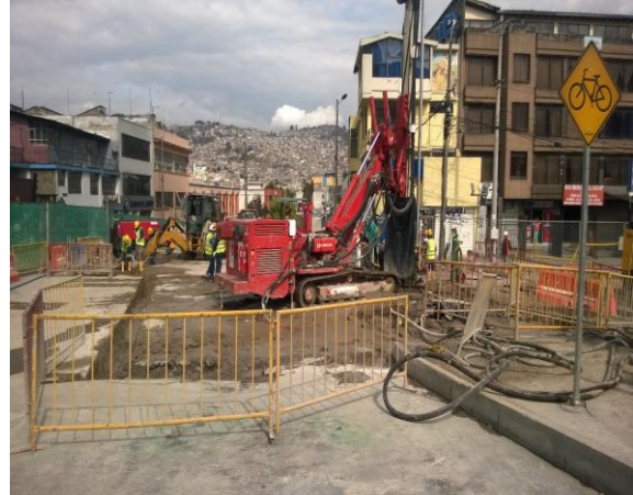
Foto 4.- 18/08/2017. Corralito Sur para la Estación La Magdalena: Perforación e inyección de taladro M336.
