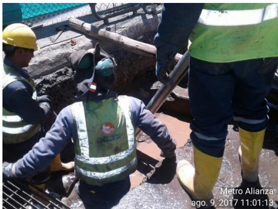
Foto 1.- 09/08/2017. Frente de Mejoramiento de Terreno 23K+500. Perforación e inyección de micropilotes en tramo #4.
