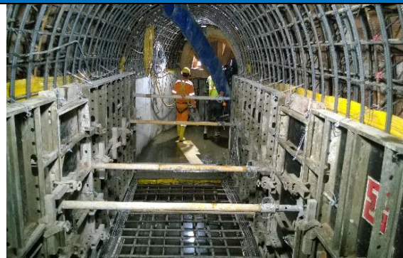
Foto #2: 09/08/2017. Avance de ejecución de galería desde el pozo PZ2 hacia aguas abajo.
