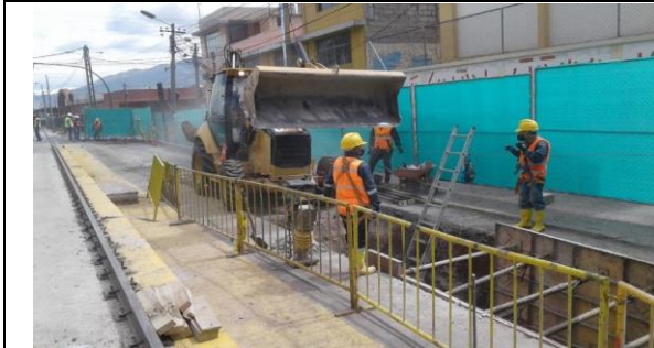
Foto #1: 31/07/2017. Excavación de colector de alcantarillado de 200mm sobre calle Rafael Arteta, estación El Recreo.
