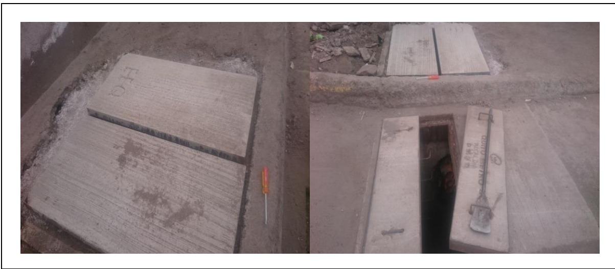
Foto 1 y 2.- Arquetas en canalización
