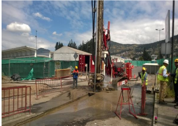
Foto 1.- 11/08/2017. Corralito Sur para la Estación La Magdalena: Inicia Perforación e inyección de taladro M310.
