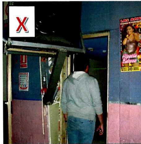
1. Obstrucción del pasillo.
