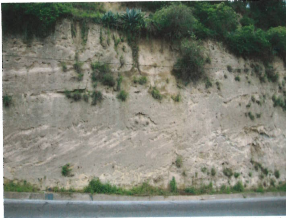
Foto de un talud en tobas con lentes de arenas volcánicas de la Formación Cangagua. Absc. 0+000 de Ruta Sur, en, Av. Simón Bolívar. Talud con corte 3:1 de 10 m de altura aproximada. Los lentes de arenas finas deben ser estabilizados mediante lechadas de cemento u otro método, pues caen por total falta de cohesión.
