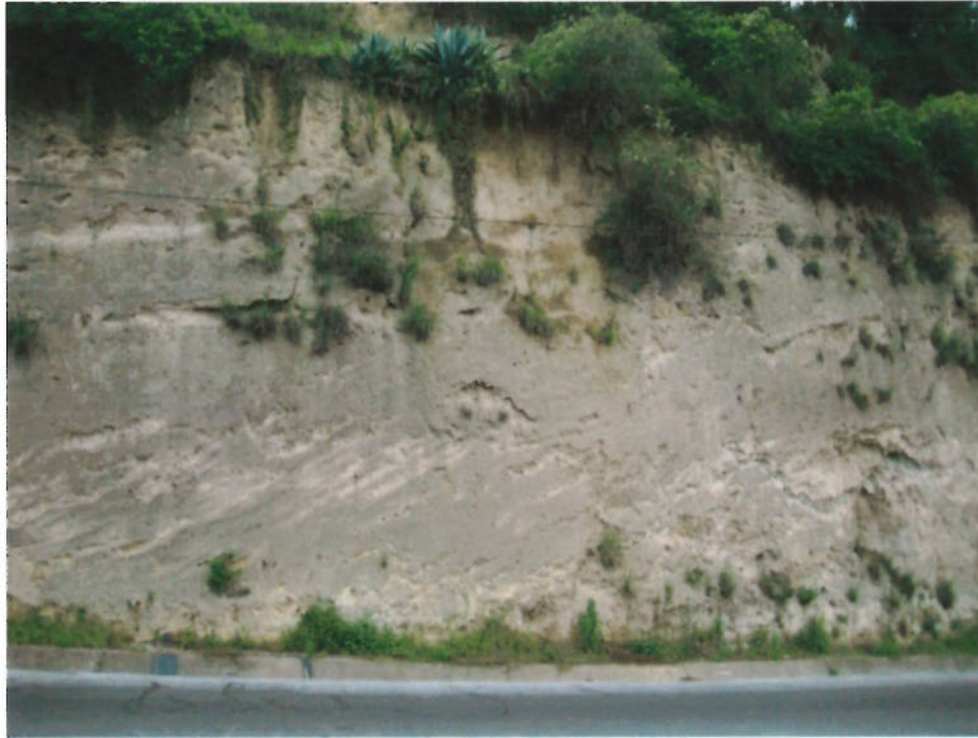
Foto de un talud en tobas con lentes de arenas volcánicas de la Formación Cangahua. Absc. 0+000 de Ruta Sur, en, Av. Simón Bolívar. Talud con corte 3:1 de 10m de altura aproximada. Los lentes de arenas finas deben ser estabilizados mediante lechadas de cemento u otro método, pues caen por total falta de cohesión.
