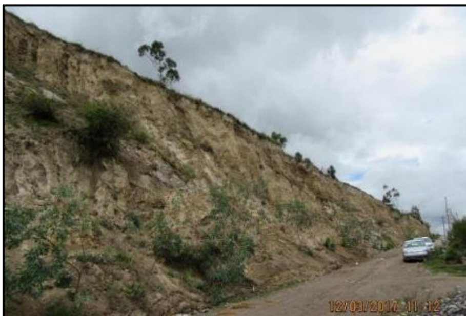
Foto N° 8.10. Barrio Pedregal, se nota la inestabilidad de los Taludes que no tienen un ángulo de reposo adecuado
