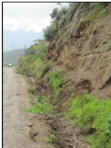
Foto N° 10.24. "Colector" semienterrado ubicado en la zanja al pie de talud
