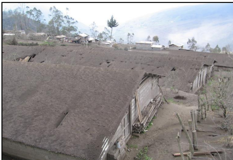
Foto N° 7.4. Techos de invernaderos colapsados producto de la caída de ceniza durante la erupción del volcán Tungurahua en el año 2006 (DNDC, 2006).
