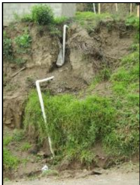
Foto N° 10.23. Tuberías de descarga de drenajes que se conectan a un "colector" al pie del talud
