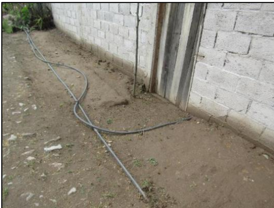
Foto N° 10.19. Tuberías superficiales y derivaciones a viviendas
