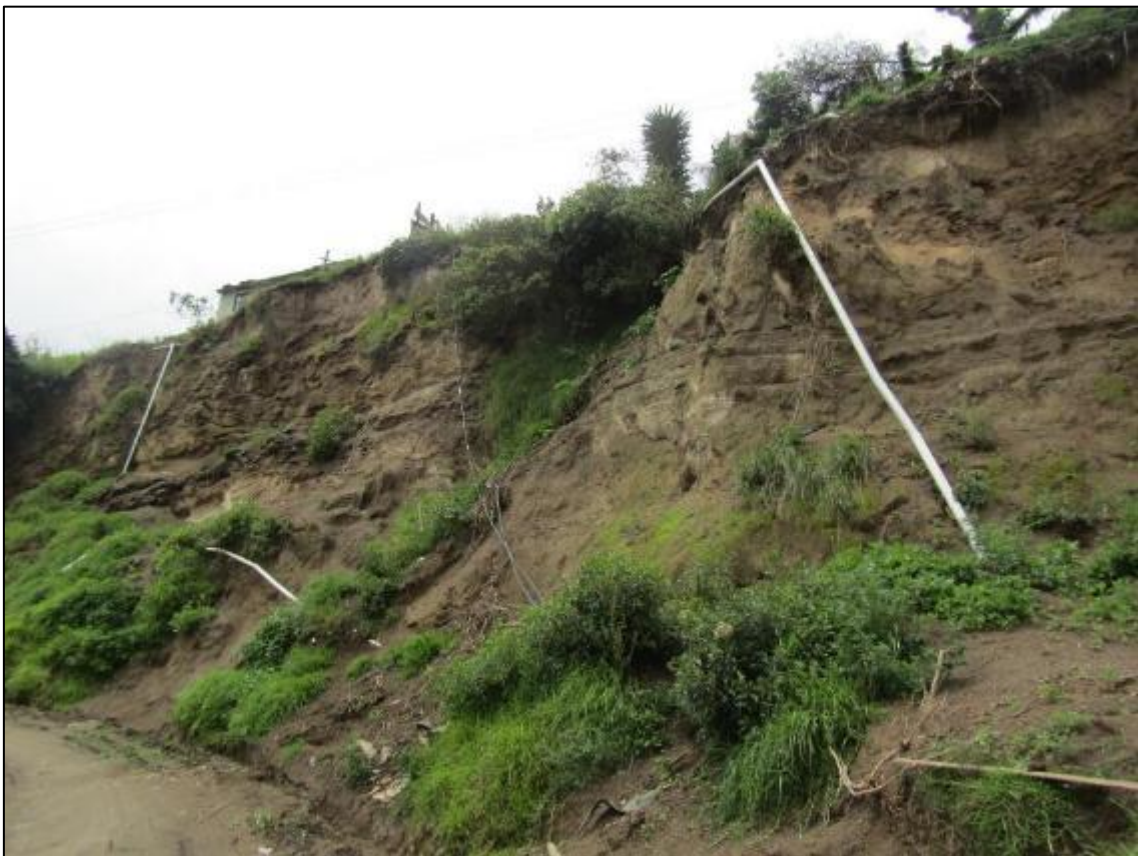
Foto N° 10.22. Tuberías de descarga de drenajes en la zona de laderas
