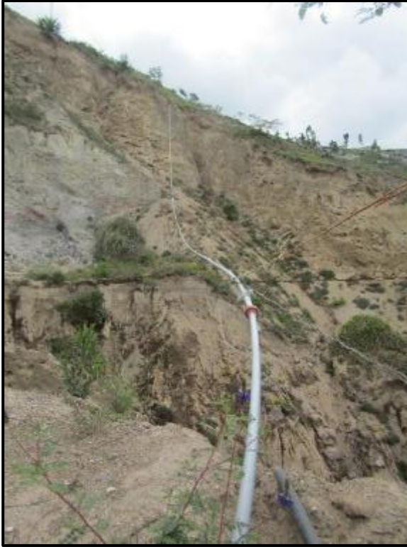
Foto N° 10.15. Cruce de quebrada con tuberías aéreas de conducción de agua, sin un sistema de soporte o sujeción
