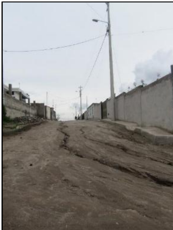
Foto N° 10.12. Camino de tierra en Cristo Rey II, con presencia de surcos
