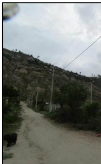
Foto N° 10.26. Postes de tendido de cables eléctricos
