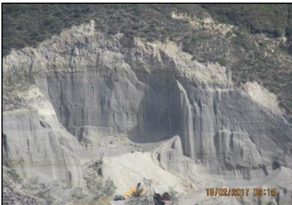
Foto N° 8.5. Cantera San Rafael I, se observa que por la pendiente fuerte se incrementa la amenaza por colapsos y caída de bloques
