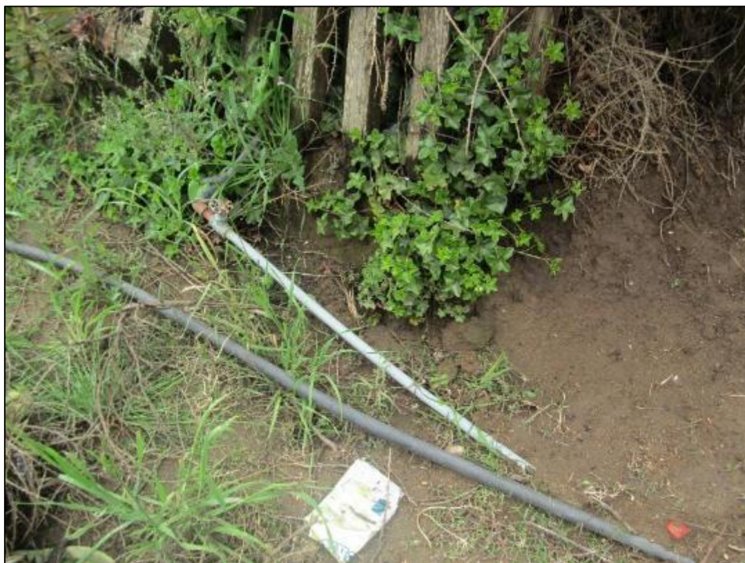
Foto N° 10.20. Conexiones para derivaciones a viviendas
