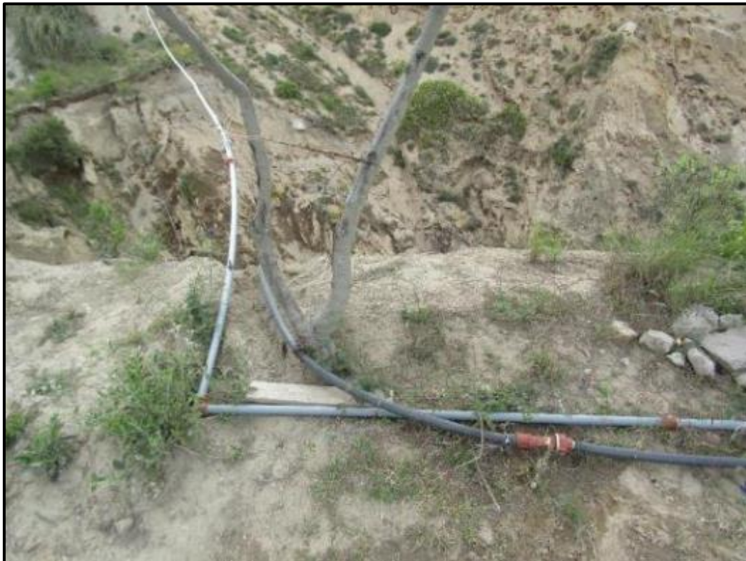
Foto N° 10.17. Conexiones para la conducción de agua en el borde superior de la quebrada
