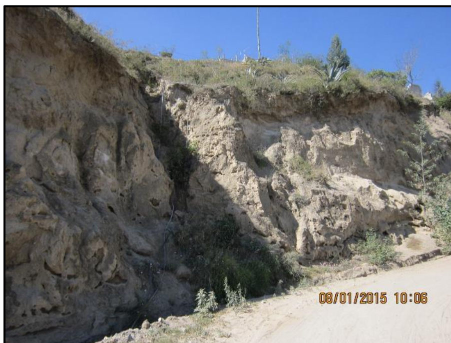
Foto N° 7.6. Efecto de erosión por corte de camino y presencia de cuneta
