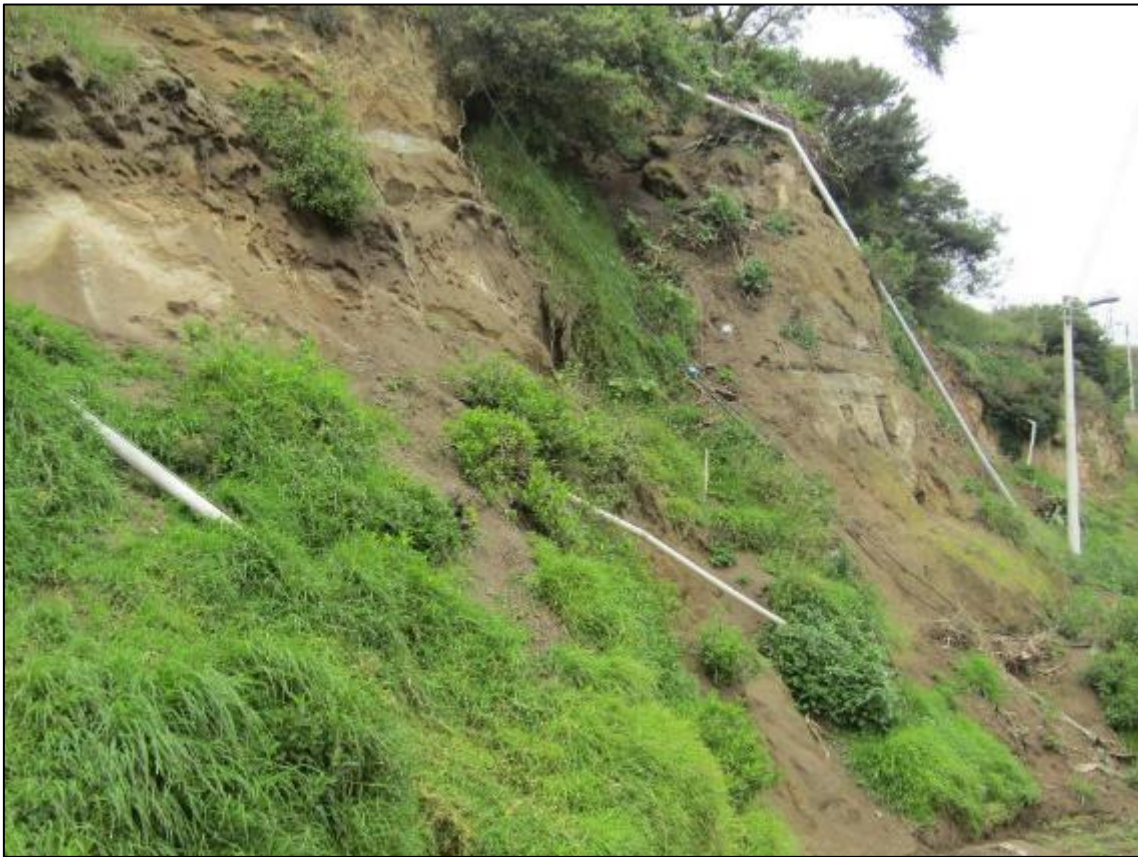
Foto N° 10.21. Tuberías de descarga de drenajes sanitarios en la zona de laderas
