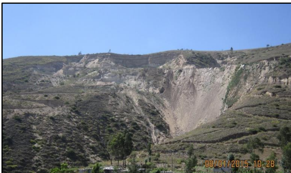
Foto N° 7.2. Cantera clandestina clausurada (al SW del proyecto, imagen 2015); se ven escombros inestables que han generado colapsos e inestabilidad de los taludes que pueden generar caídas.
