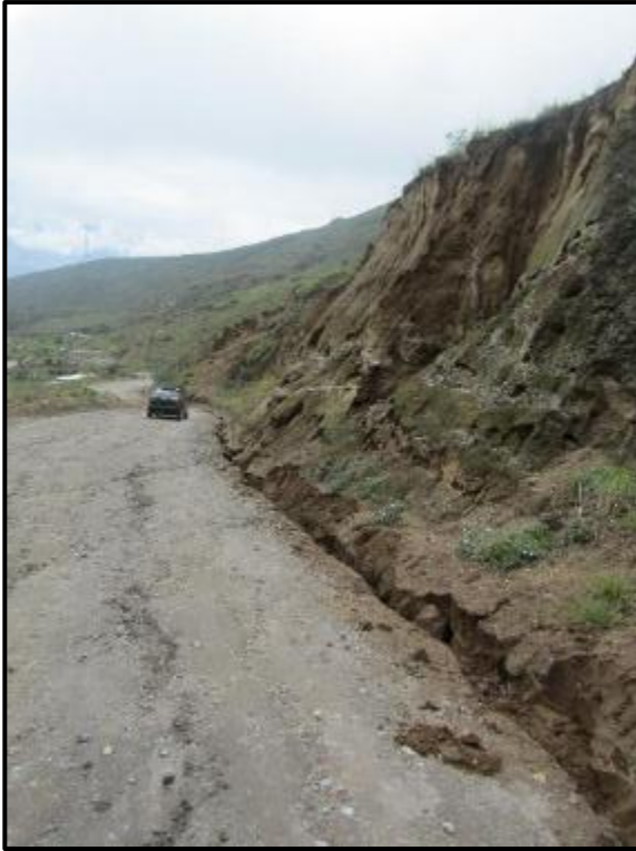
Foto N° 10.10. Camino de tierra en la bajada hacia Planada de San Francisco, con zanja al pie del talud
