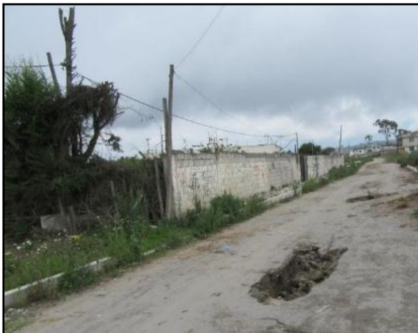
Foto N° 8.15. Barrio Cristo Rey I, zona plana con muy baja susceptibilidad por inestabilidad de terrenos, no obstante se pueden generar hundimientos por mal manejo del agua
