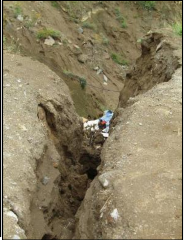
Foto N° 10.11. Descarga de la zanja hacia la quebrada, con presencia de basura
