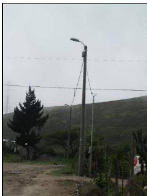
Foto N° 10.25. Sistema eléctrico, iluminación y medidores
