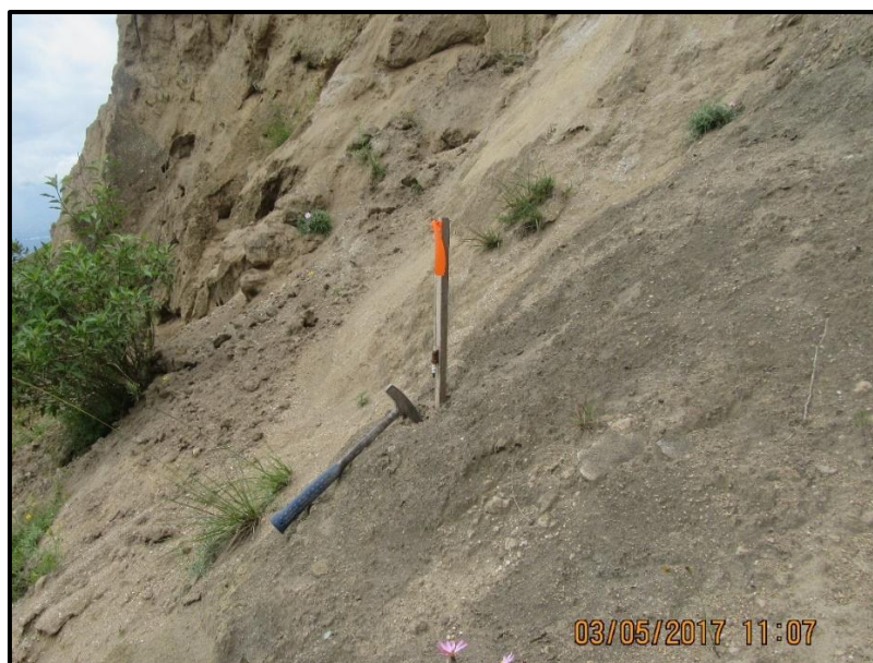
Foto N° 14.9. La misma estaca en Mayo / 2017, se puede notar claramente que no ha sufrido cambios, tiene polvo pero no se observa cambios en el nivel.
