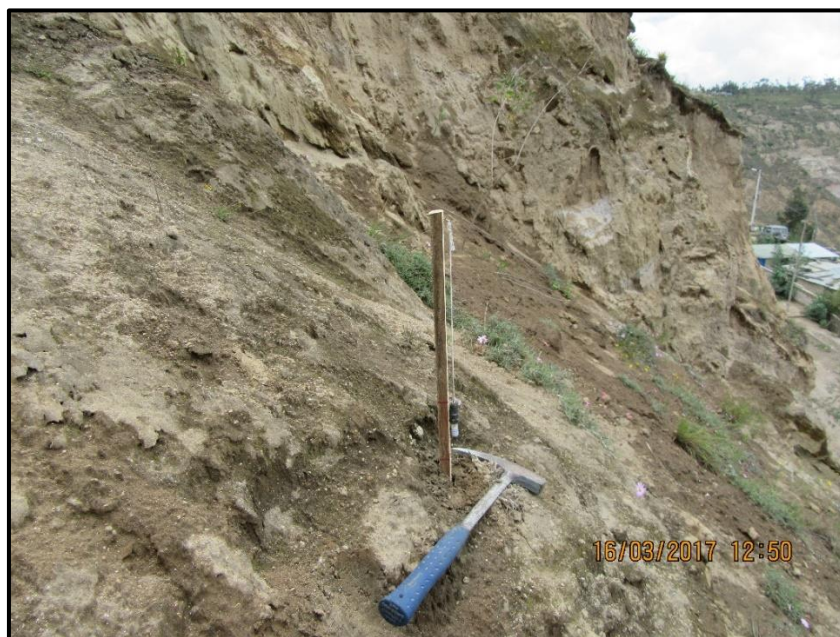
Foto N° 14.8. Estaca con nivel colocada en Marzo/2017; parte del sistema de monitoreo del SAT en Pedregal.
