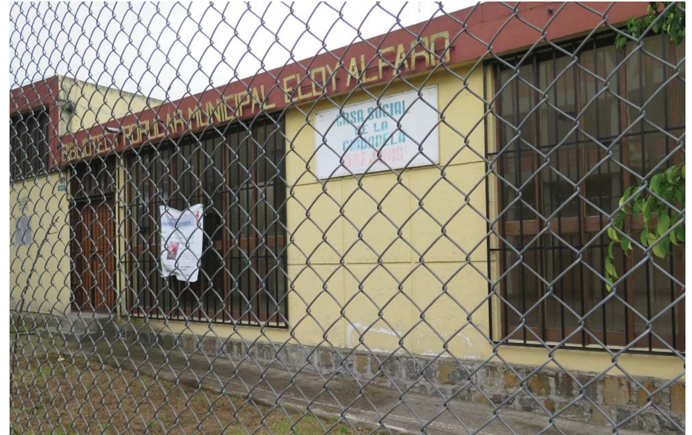
Biblioteca Municipal en mal estado
