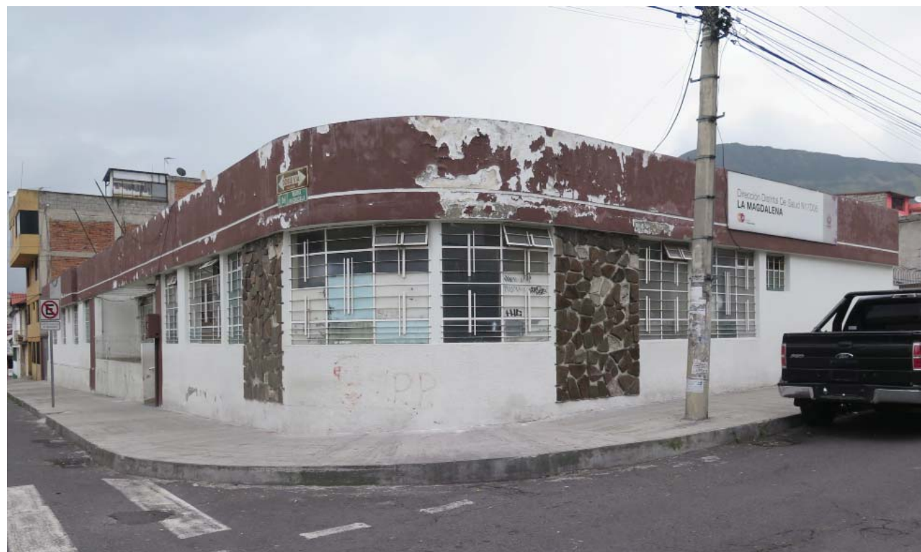
Dirección de Salud en mal estado
