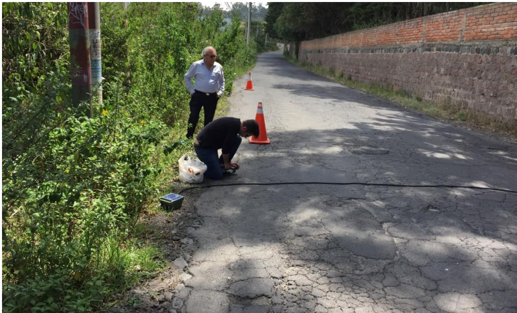
Ilustración 3-4: Colocación contador automático en la Calle Alfonso Lamiña a 600 metros de la Ruta Viva Fuente: A&V Consultores
