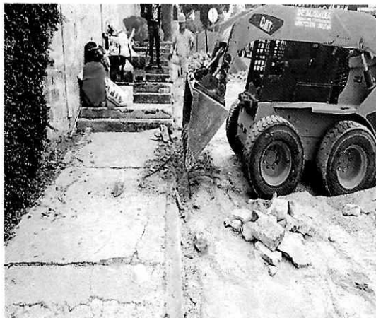
ROTURA DE PAVIMENTO EN ACERAS
