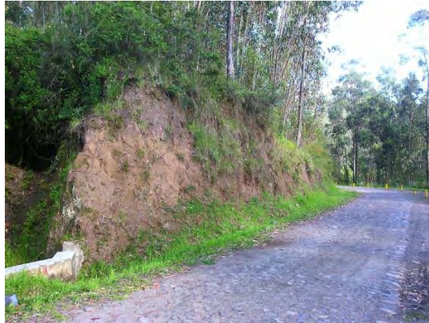
Fotografía N° 6.1-1: Talud del Camino donde aflora la capa de suelo compuesto por limos arcillosos
