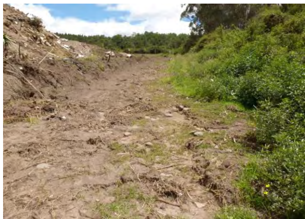
FOTOGRAFIA N°7: Camino parcialmente destruido, ubicado en el límite norte de la escombrera Troje IV.
