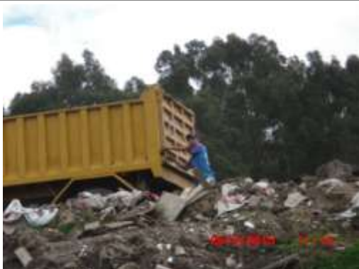
FOTOGRAFÍA N° A7-17: Personal externo sin uso de EPP dentro de la escombrera Sitio: Escombrera Troje IV Tomada por: Mireya T
