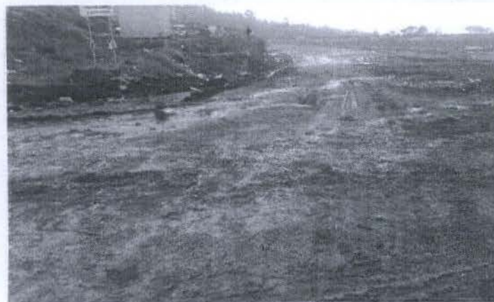
PLATAFORMA PRINCIPAL AFECTADA POR LLUVIAS
