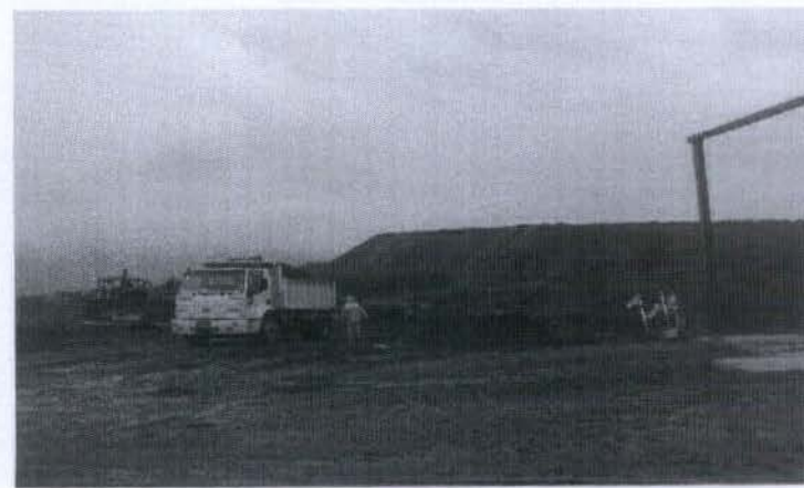
ACOPIO EN PLATAFORMA SUPERIOR DE EMERGENCIA POR LLUVIAS
