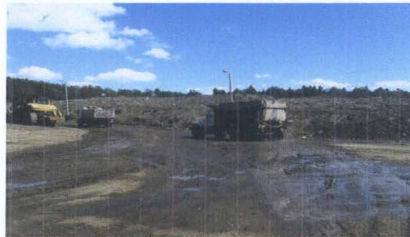
CONTROL DE POLVO CON RIEGOS CONSTANTES DE AGUA DENTRO DE LA ESCOMBRERA
