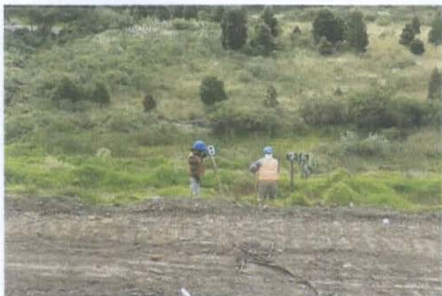
BALIZADO Y NUMERACION DE BERMAS EN PLATAFORMA LADO ESTE DE LA ESCOMBRERA
