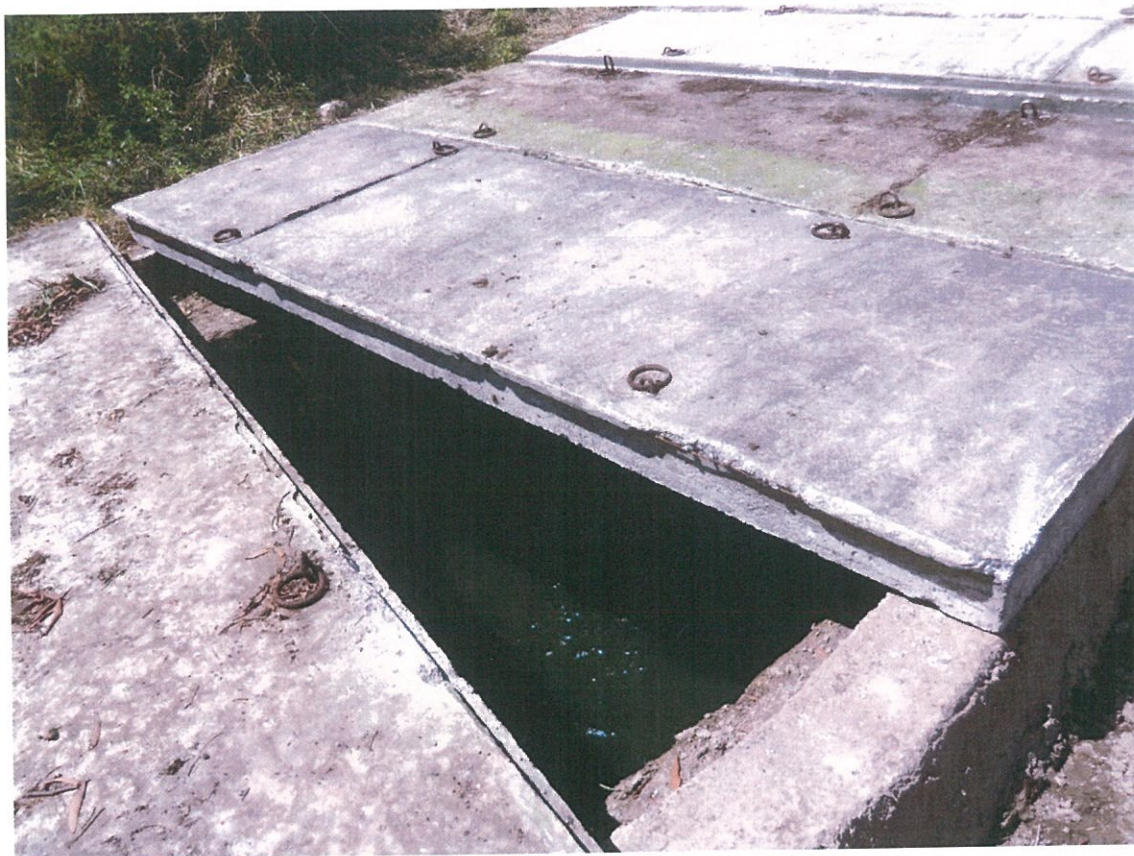
Foto 6 NO CONFINAMIENTO de las tapas de cobertura del canal y espacios abiertos peligrosos porque pueden caer niños o animales. VJ 2017/12/08
