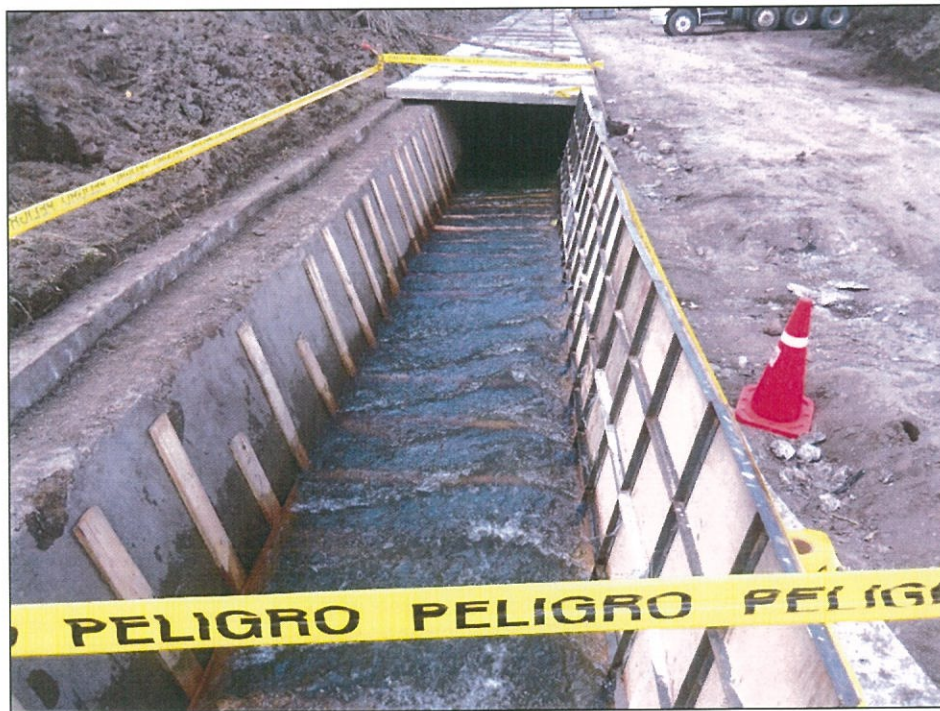
Foto 5 Canal en reparación en su muro lateral derecho en una l \approx 25\text{m} . Las losetas de hormigón empleadas como tapas de cobertura del canal, tiene un largo de 3,30\text{m} , un ancho de 1,00\text{m} y un espesor de 20\text{cm} y no tienen confinamiento en el canal, lo cual les hace propensas a su desplazamiento ante aludes como el ocurrido. VJ 2017/12/08
