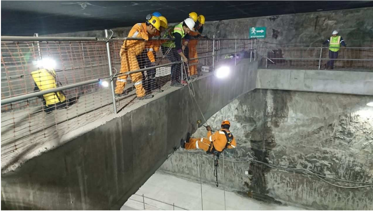
Frente de Obra: Cardenal de la Torre | Descripción: Instrucción de Rescate y Proceso Evacuación
