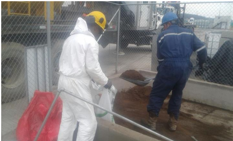
Material contaminado almacenado en costales
