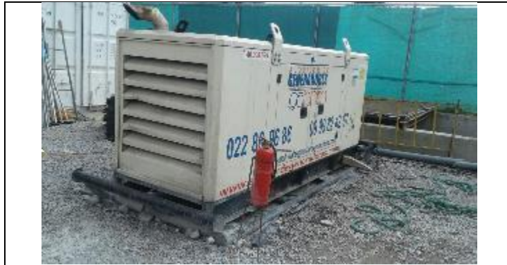
Generador con cubeto y cabina de insonorización
