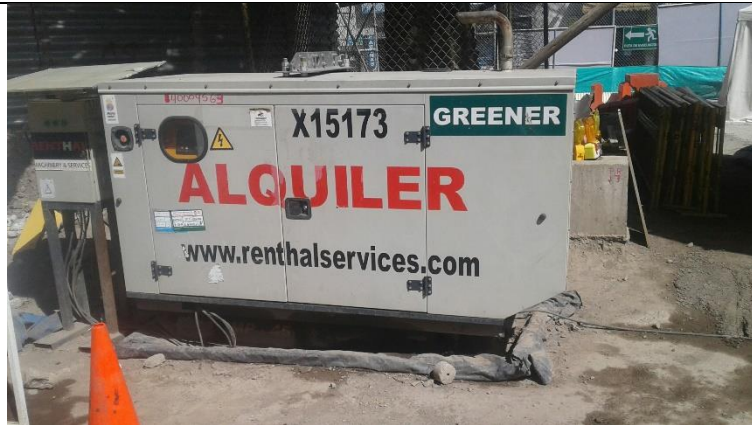
Generador con cubeto
