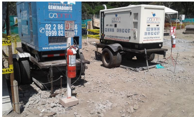
Cubetos en generadores
