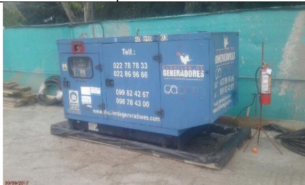
Cubeto para equipos
