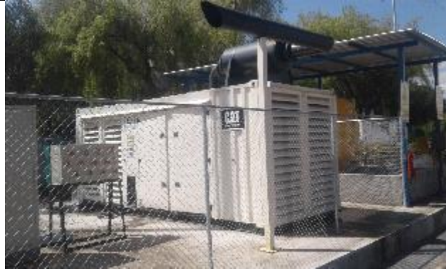
Generadores con cubeto y cabina de insonorización
