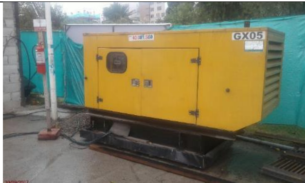
Cubeto para equipos
