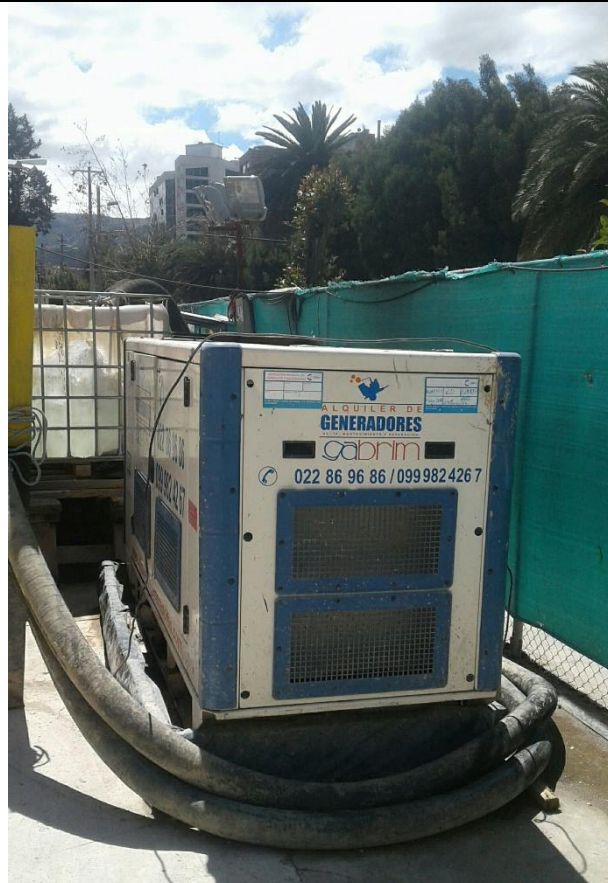
Cubeto para generador
