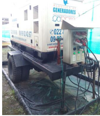
Cubeto en generador
