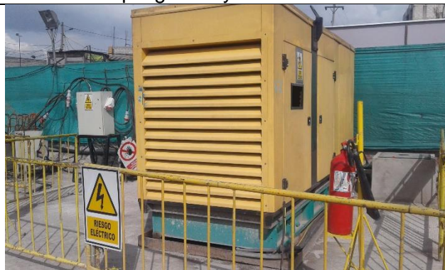
Generador con cubeto y cabina de insonorización
