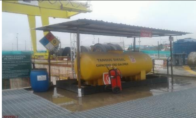
Almacenamiento de combustible
