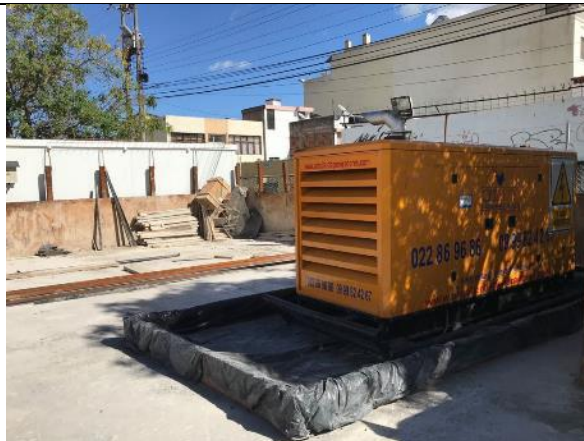
Generador con cubeto
