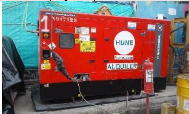
Generador con cubeto y cabina de insonorización
