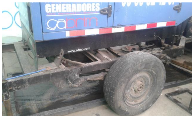
Cubeto en generador
