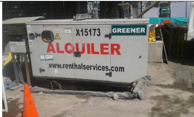
Generador con cubeto
