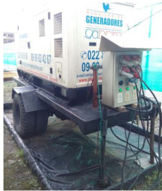
Cubeto en generador
