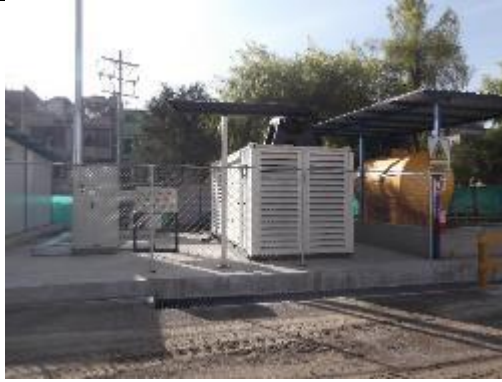
Generadores con cubeto y cabina de insonorización
