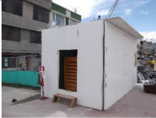
Generador con cubeto y cabina de insonorización
