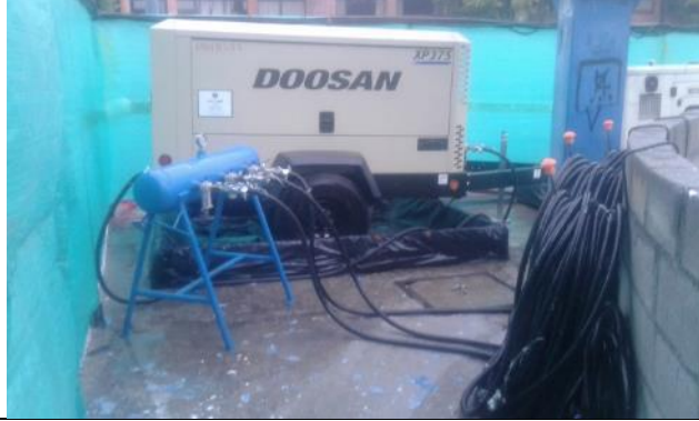
Cubeto de equipos
