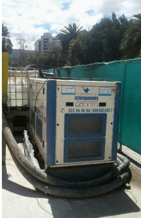
Cubeto para generador
