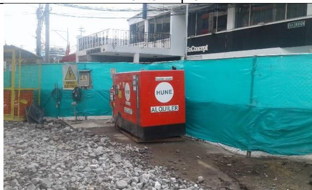
Generador con cubeto
