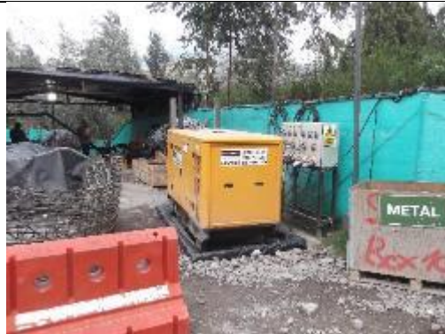
Generador con cubeto y cabina de insonorización
