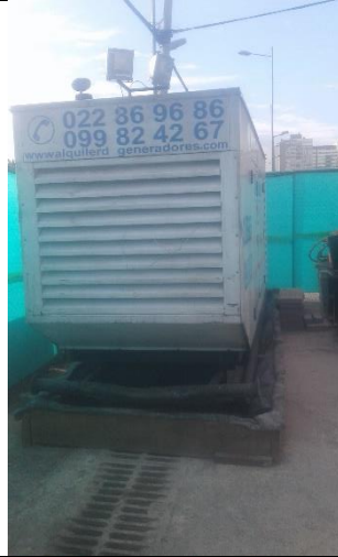
Cubeto de equipos
