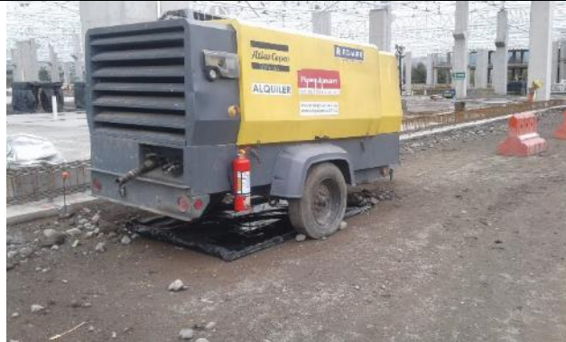
Generador con cubeto y cabina de insonorización
