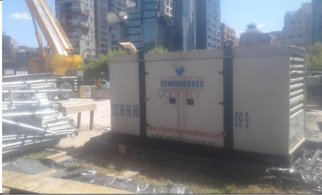
Cubeto de equipos
