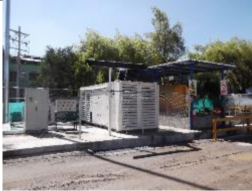
Generadores con cubeto y cabina de insonorización
