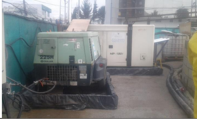
Cubeto de equipos
