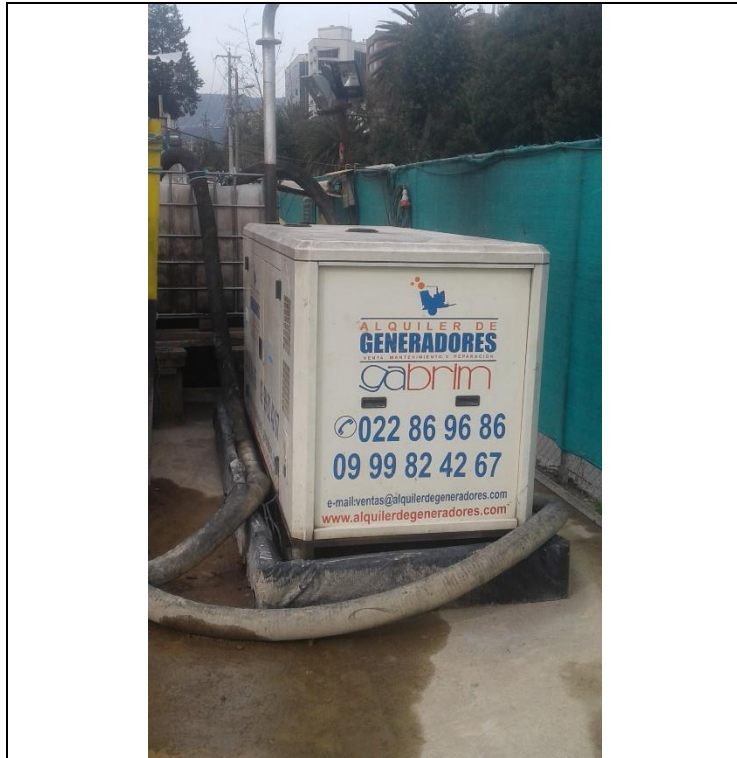
Cubeto para generador
