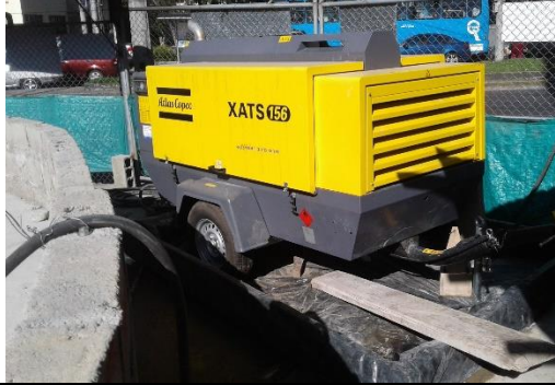
Cubeto de equipos
