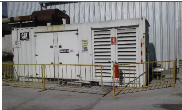
Generadores con cubeto y cabina de insonorización
