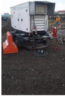
Generador con cubeto y cabina de insonorización
