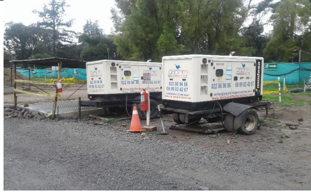
Cubetos en generadores
