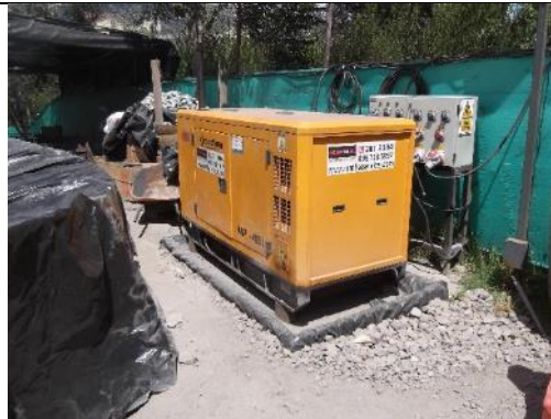
Generador con cubeta y cabina de insonorización
