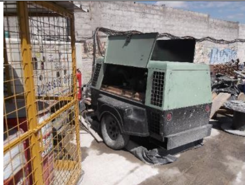
Generadores con cubeto y cabina de insonorización
