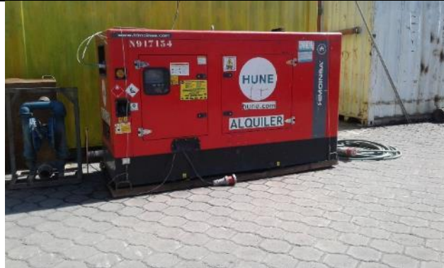
Generador con cubeto y cabina de insonorización
