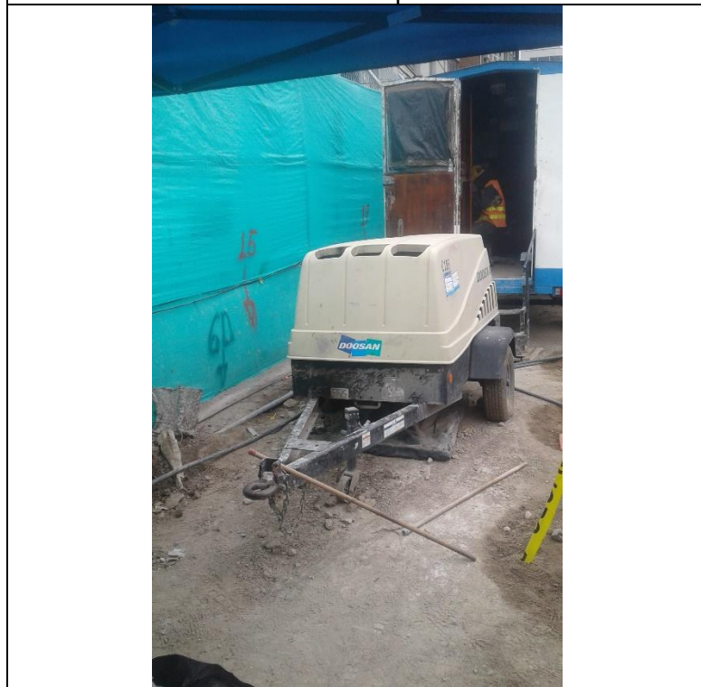
Generador con cubeto
