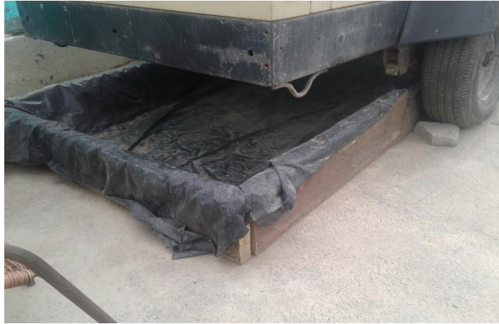
Cubeto en torre de iluminación
