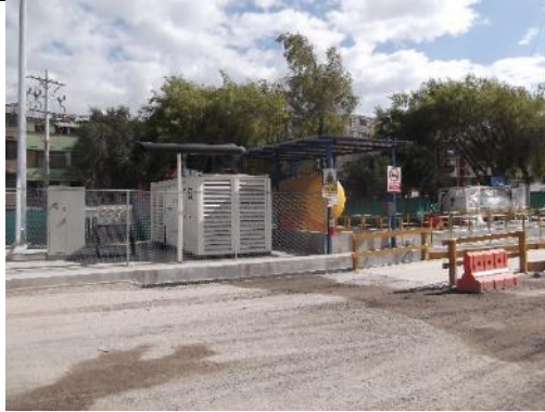
Generadores con cubeto y cabina de insonorización
