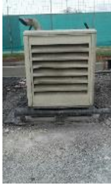
Generador con cubeto y cabina de insonorización
