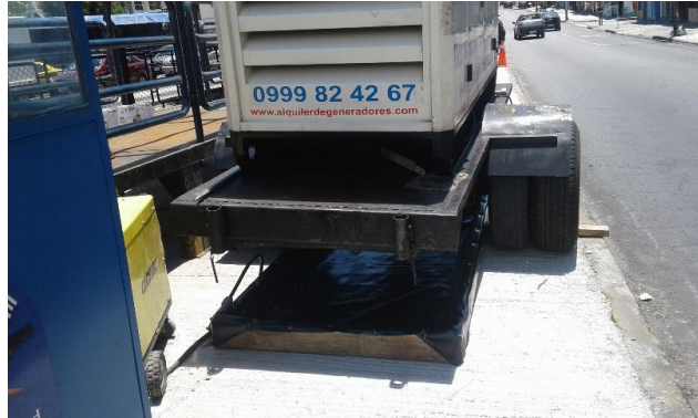
Cubeto en generador
