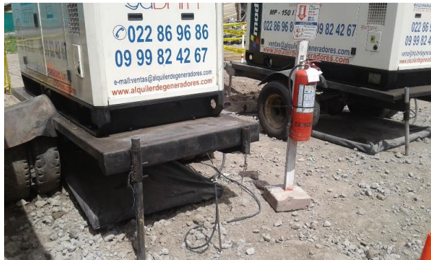
Cubetos en generadores
