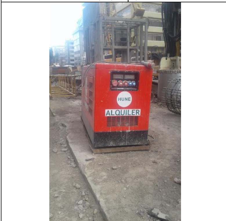
Generador con cubeto
