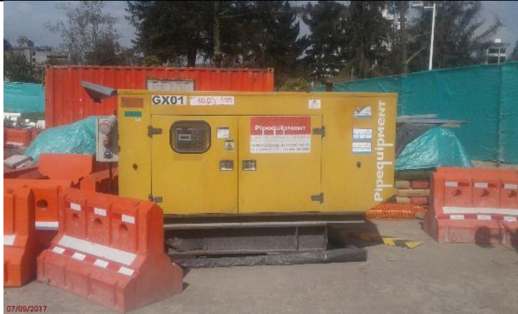
Generador con cubeto
