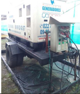
Cubeto en generador
