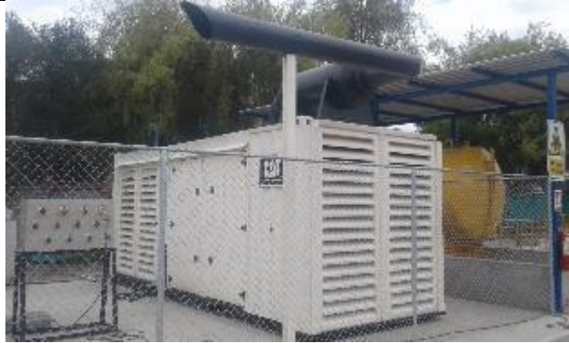
Generadores con cubeto y cabina de insonorización
