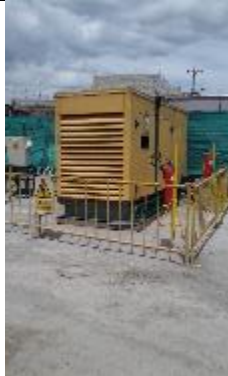
Generador con cubeta y cabina de insonorización
