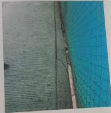
vereda y bordillo dañados
