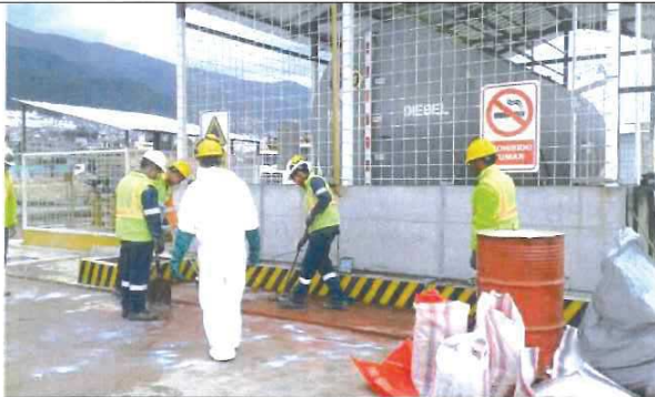
Limpieza del área con desengrasante y material absorbente contaminado recogido en fundas y costales.
