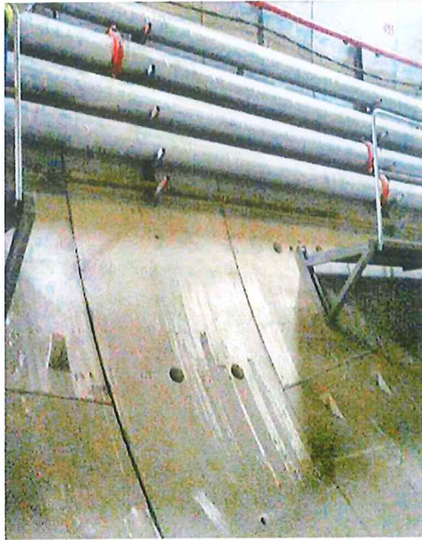
Imagen 1. Tramo de baranda caído en pasarela de túnel.
