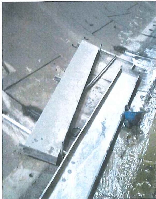
Imagen 2. Pasarelas caídas donde se posicionaba el trabajador.
