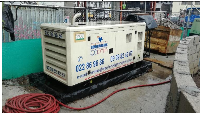
Cubeto para generador
