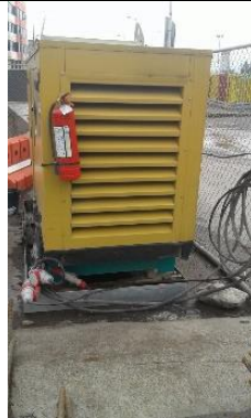
Generador con cubeta y cabina de insonorización
