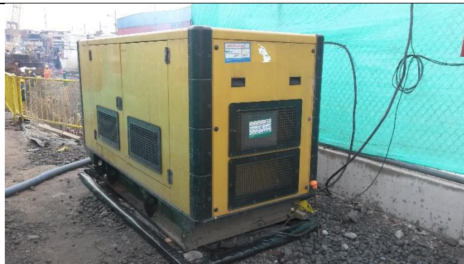
Generador con cubeto y cabina de insonorización
