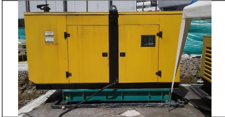
Cubeto para generadores
