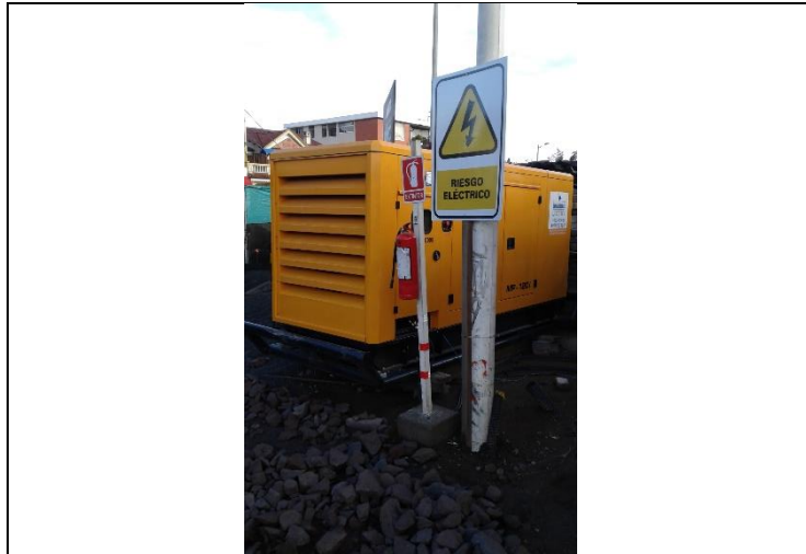
Generador con cubeto
