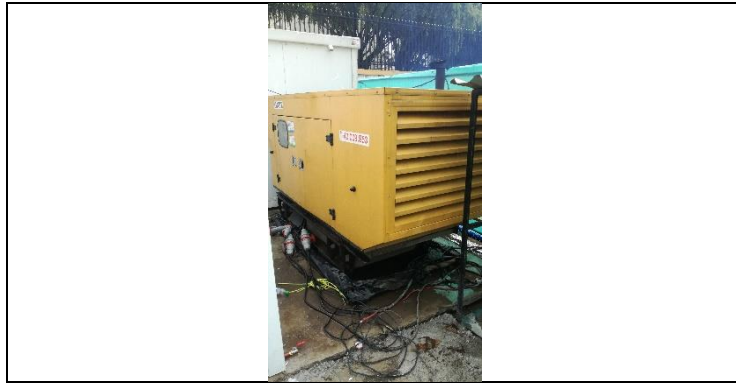
Generador con cubeto
