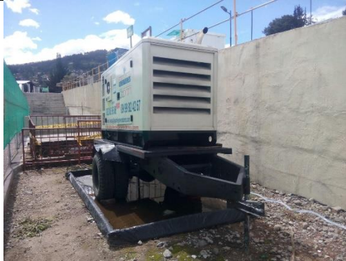
Generador con cubeto y cabina de insonorización
