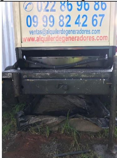
Generador con cubetos
