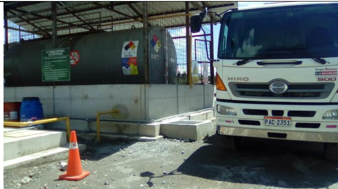
Almacenamiento de combustible
