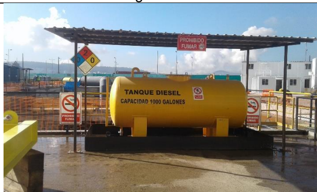
Almacenamiento de combustible
