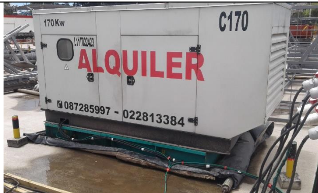
Generadores con cubeto y cabina de insonorización
