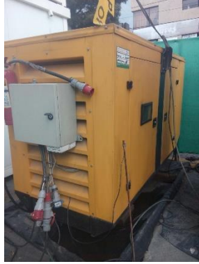
Generador con cubeto y cabina de insonorización
