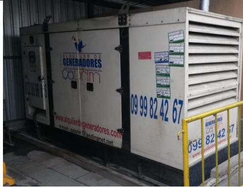
Generador con cubeto y cabina de insonorización
