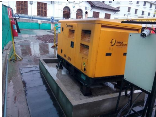
Generador con cubeto y cabina de insonorización
