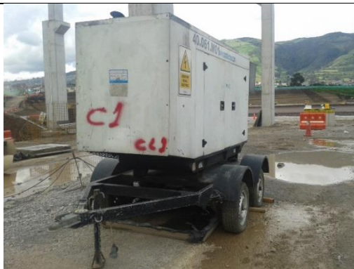
Generador con cubeto y cabina de insonorización
