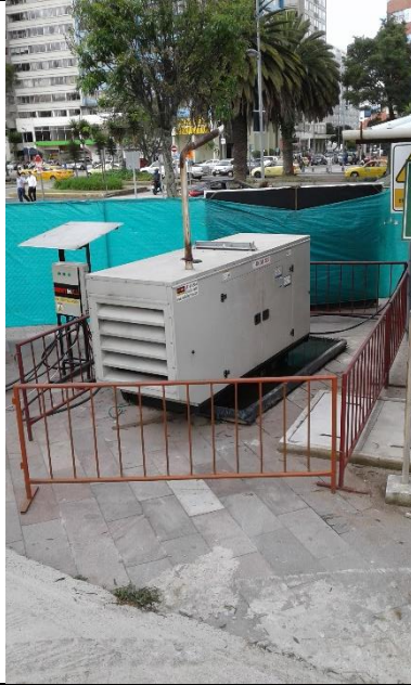
Generador con cubeto
