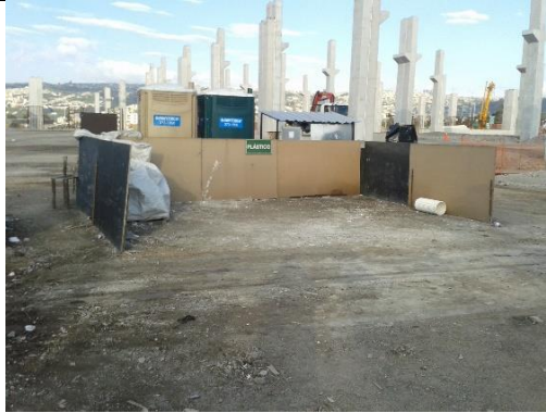
Área de almacenamiento temporal de residuos metálicos
