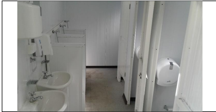
Baños conectados a alcantarilla
