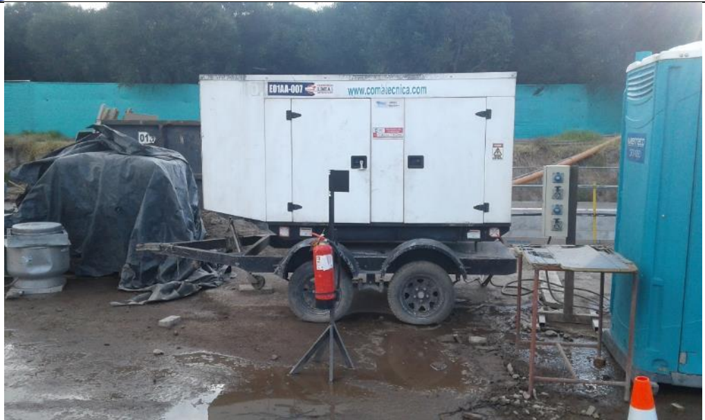
Generador con cubeto
