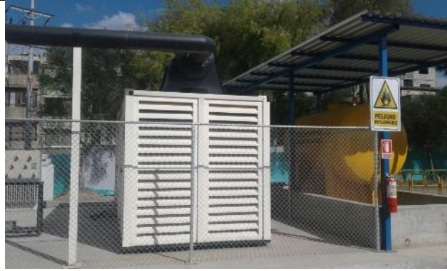
Generadores con cubeto y cabina de insonorización
