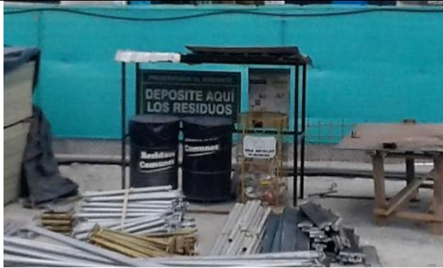
Separación de residuos
