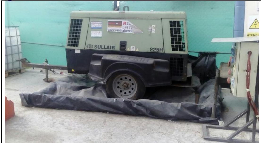
Cubeto para generador
