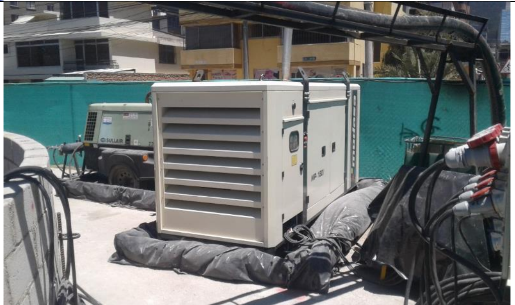
Cubeto para generador
