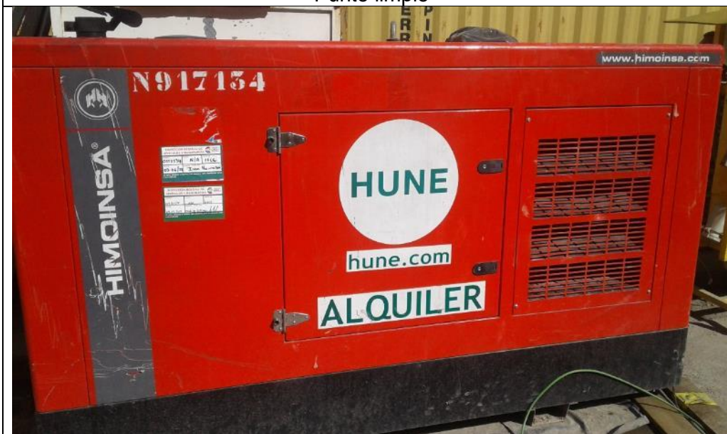
Generador con cubeto
