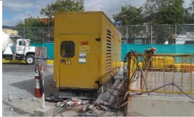
Generador con cubeto y cabina de insonorización
