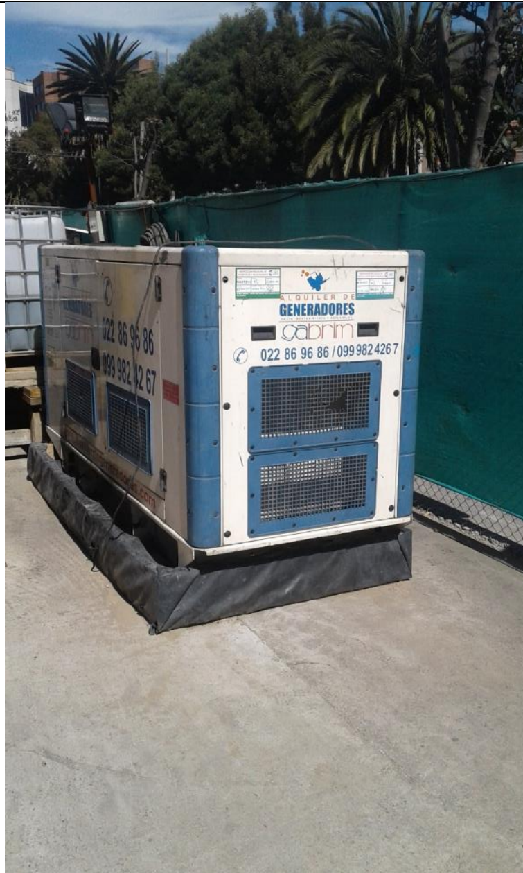
Cubeto para generador
