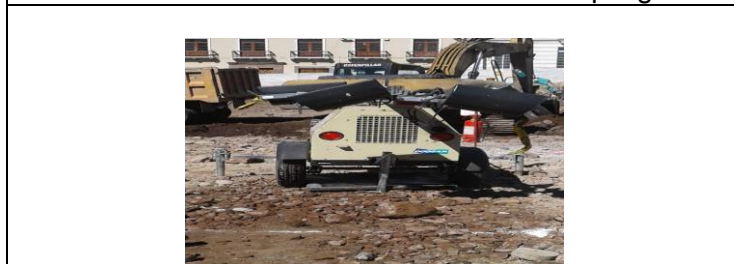
Torre de iluminación con su respectivo cubeto
