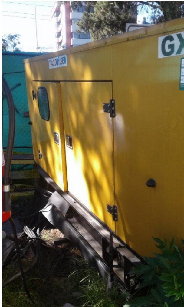
Generador con cubeto
