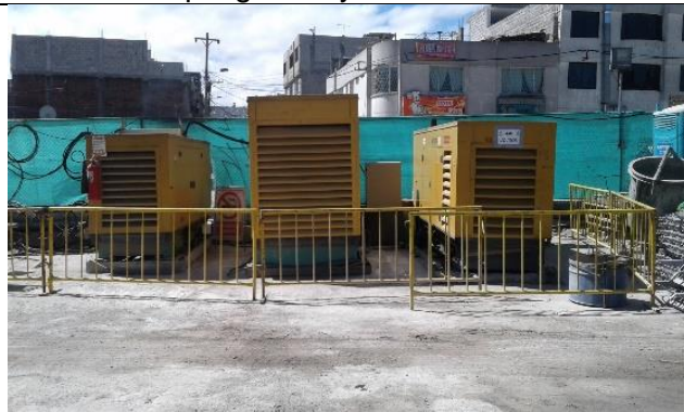
Generador con cubeto y cabina de insonorización
