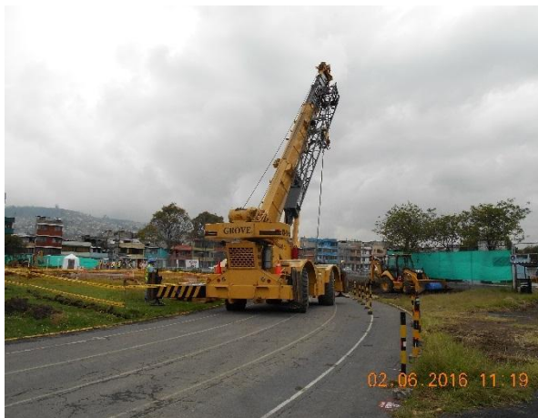
Foto 118.- Grúa telescópica en la Estación Solanda.
