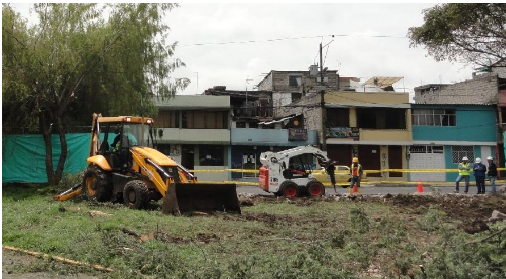
Foto 51.- Derrocamiento de muros en la construcción de puerta de acceso. Estación Solanda
