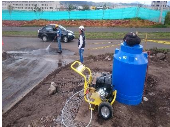
Foto 44.- Área de lavado de neumáticos.
