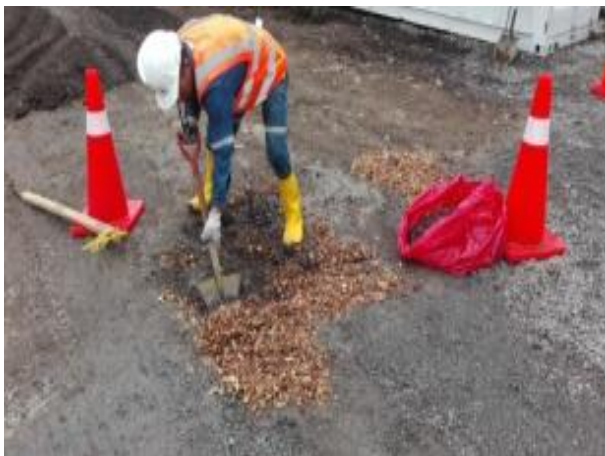
Foto 83.- Actuación control de derrame en Patio de Talleres y Cocheras.
