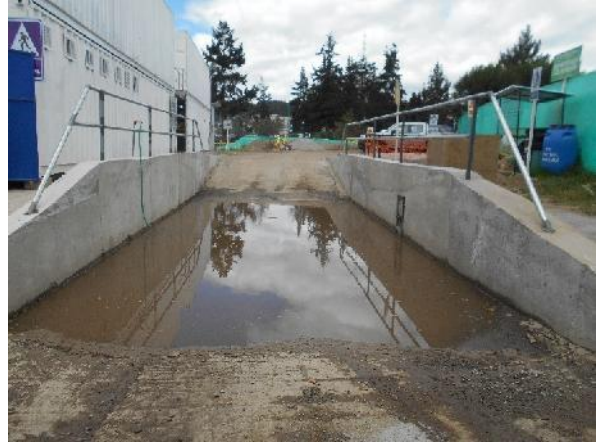
Foto 144.- Área de lavado de neumáticos en la Estación Iñaquito.
