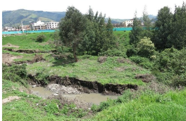
Foto 3. Drenaje Quebrada Ortega
