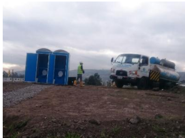
Foto 103.- Limpieza y mantenimiento de letrinas químicas móviles.
