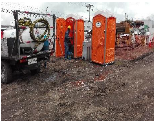
Foto 81.- Control en mantenimiento de letrinas en Patio de Talleres y Cocheras.
