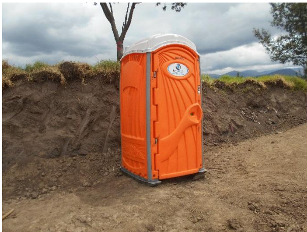
Foto 102.- Letrinas químicas móviles disponibles en frentes de obra.
