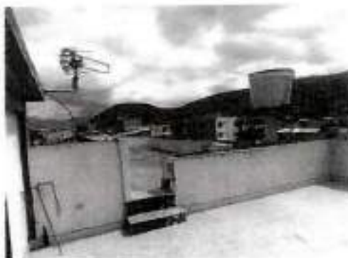
Foto N°24 Vista de terraza inclinada
