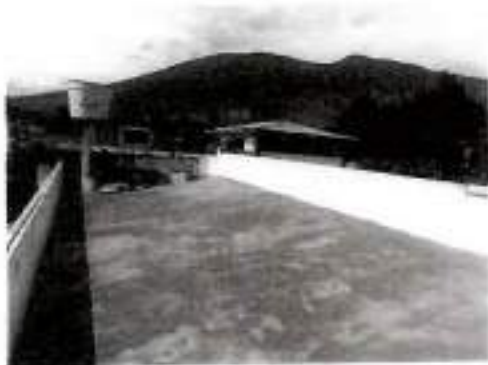
Foto N°25 Vista de terraza inclinada
