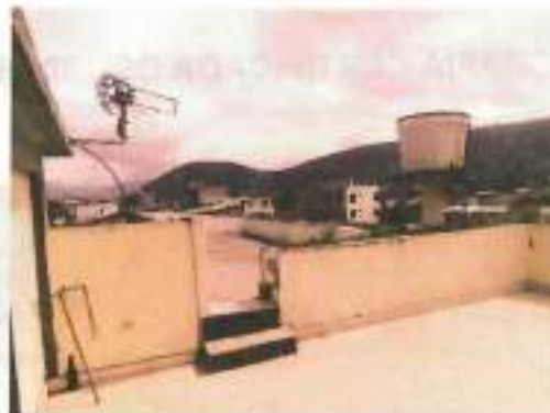
Foto N°24 Vista de terraza inclinada
