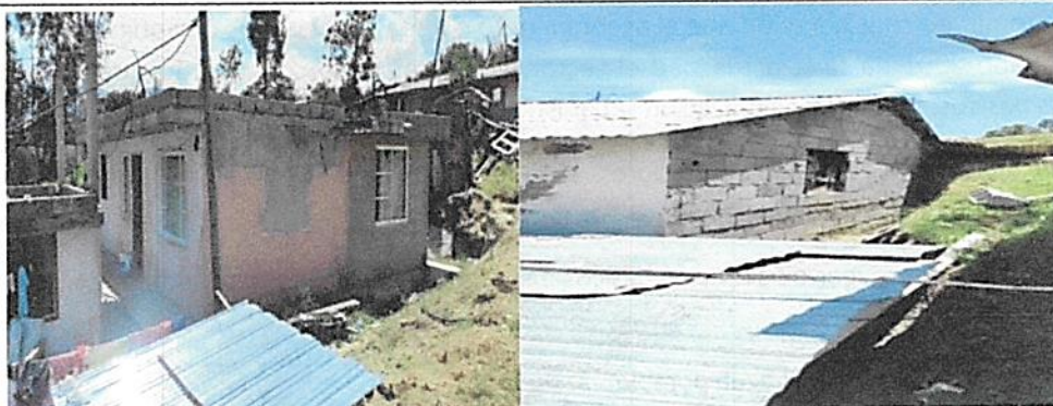
Gráfico 3. Vivienda con calidad estructural reducida del AHHyC "Curiqingue II Etapa".
