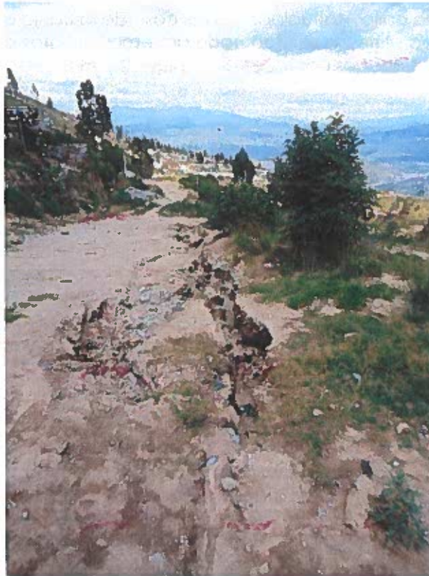
Foto 8. Estado actual de las calles en el Barrio Los Eucaliptos de Calderón. Note que la falta de alcantarillado, cunetas, sumideros, etc., provocan la erosión y el deterioro de las calles.
