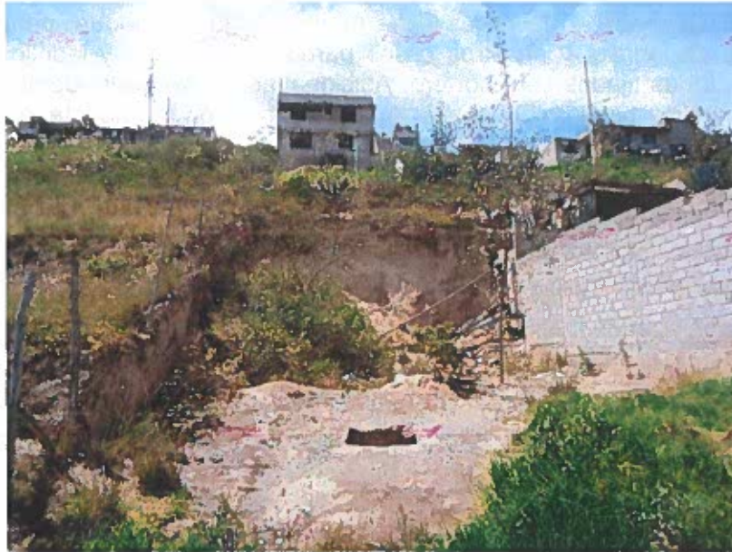
Foto 5. Desbanques de tierras efectuados para posibles construcciones futuras en el lado oriental del Barrio Los Eucaliptos de Calderón. Note que los taludes generados están desprotegidos y la presencia de edificaciones sobre esos taludes.
