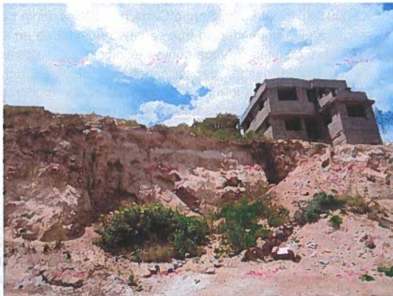
Foto 1. Talud vertical desprotegido, de 4-5 metros de altura, muy afectado por erosión y deslizamientos de tierra. Se observa una construcción de 2 pisos sobre dicho talud.
