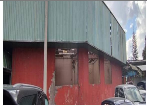
En estas instalaciones no hay techo, ventanas, puertas
