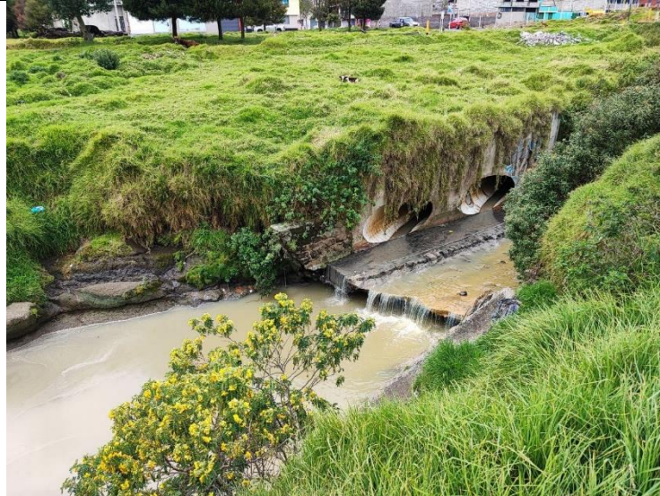
Foto 1. Descarga de alcantarillado
