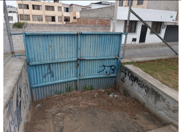
Foto 2: Puerta Este (inhabilitado)
