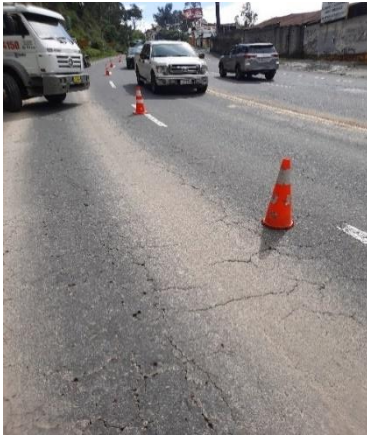
Foto 1. Falla tipo "Piel de cocodrilo" km 7 Bache. Km 21+500. Calzada derecha
