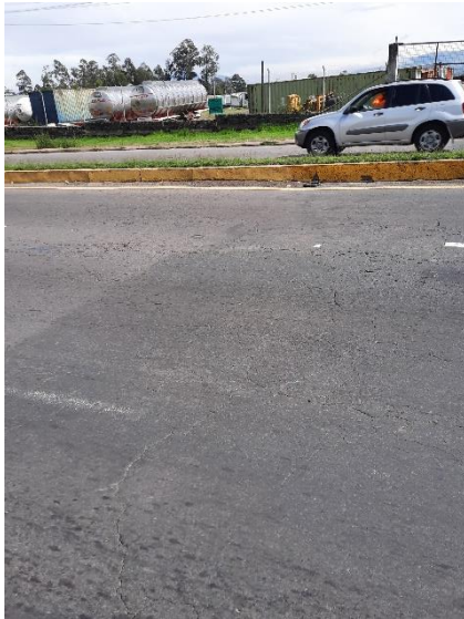
Foto 3. Desgastes. Km 20. 7+500. Calzada derecha.
