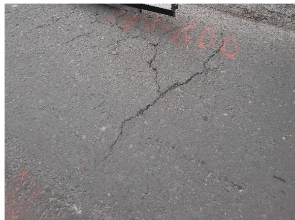
Foto 6. Grieta transversal, km 14+600. Calzada derecha.
