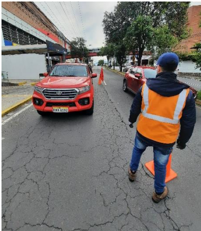
Foto 5. Piel de cocodrilo. Km 12+100 Calzada izquierda
