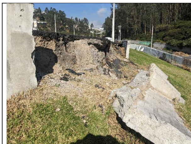
Fotografía 21. Vista de colapso en desnivel de placa prefabricada..
