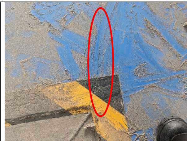
Fotografía 9. Vista de fisura en piso de edificación tipología 1.
