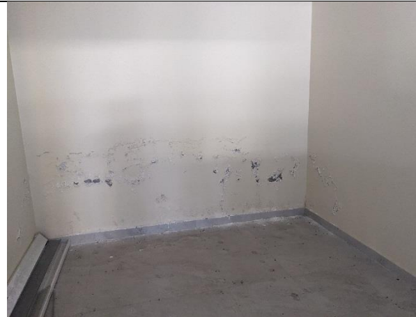
Fotografía 12. Vista de humedad en interior de edificación tipología 2.
