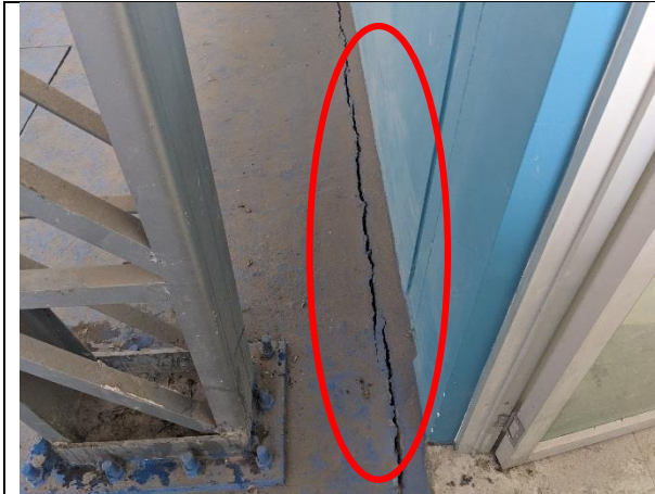
Fotografía 11. Vista de fisura de separación entre edificaciones de tipología 1 y tipología 2.
