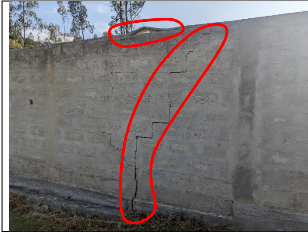
Fotografía 17. Vista de fisura en cerramiento perimetral.
