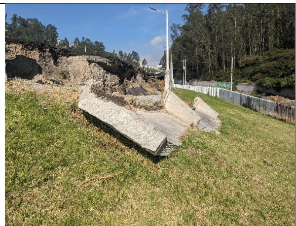
Fotografía 20. Vista de colapso en desnivel de placa prefabricada.
