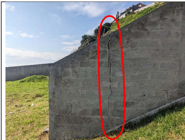
Fotografía 13. Vista de fisura en cerramiento perimetral.
