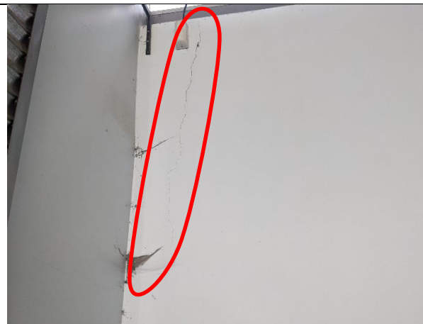
Fotografía 10. Vista de fisura en mampostería, en edificación de tipología 1.
