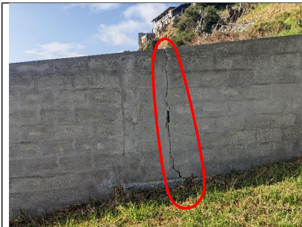
Fotografía 15. Vista de fisura en cerramiento perimetral.
