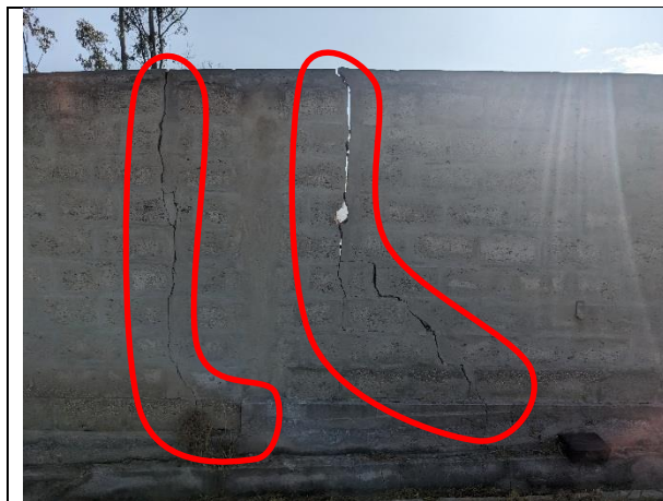
Fotografía 19. Vista de fisura en cerramiento perimetral.
