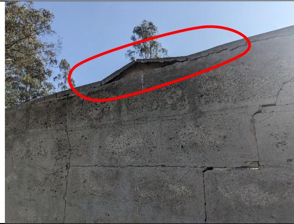
Fotografía 18. Vista de fisura en cerramiento perimetral.
