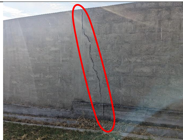
Fotografía 16. Vista de fisura en cerramiento perimetral.
