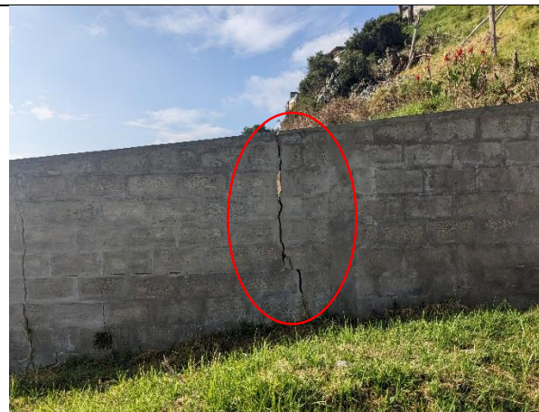
Fotografía 14. Vista de fisura en cerramiento perimetral.
