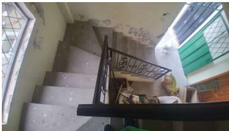
F.5 Edificaciones existentes bloque de gradas estructura de hormigón armado óptimas condiciones
