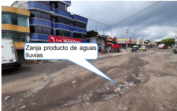
FOTO 7: "ZANJAS PRODUCIDAS POR LAS AGUAS LLUVIAS"
