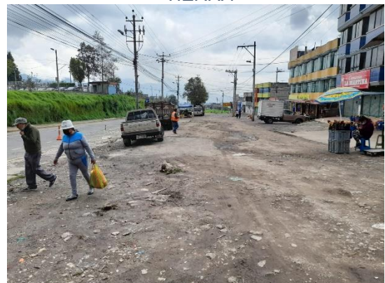
FOTO 10: "DETERIORO DE LA CALZADA EN TIERRA"
