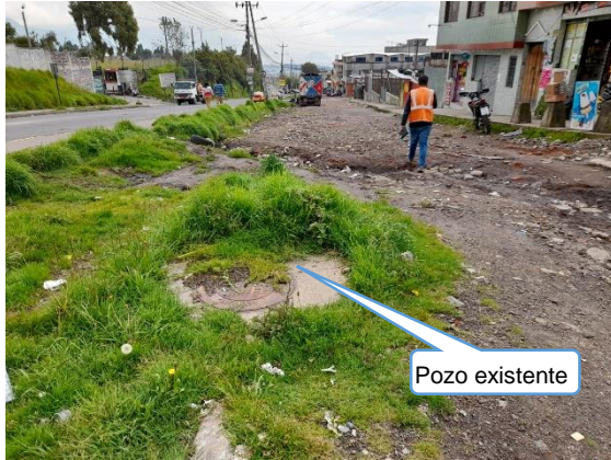
FOTO 5: "CALZADA DERECHA EN TIERRA, CONDICIONES PRECARIAS"
