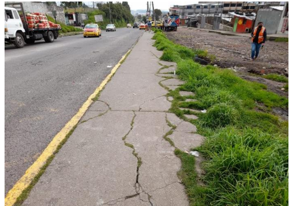
FOTO 4: "PARTERRE CENTRAL DETERIORADO"
