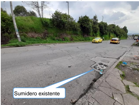
FOTO 3: "ASFALTO DETERIORADO CALZADA IZQUIERDA"
