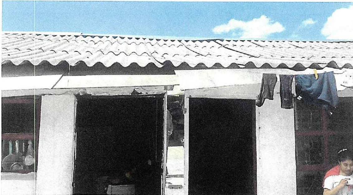
Viviendas con calidad estructural reducida; se evidencias estructuras antiguas con alto nivel de deterioro y material obsoleto.
