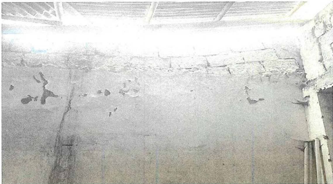
Viviendas con calidad estructural reducida; se evidencias estructuras antiguas con alto nivel de deterioro y material obsoleto.
