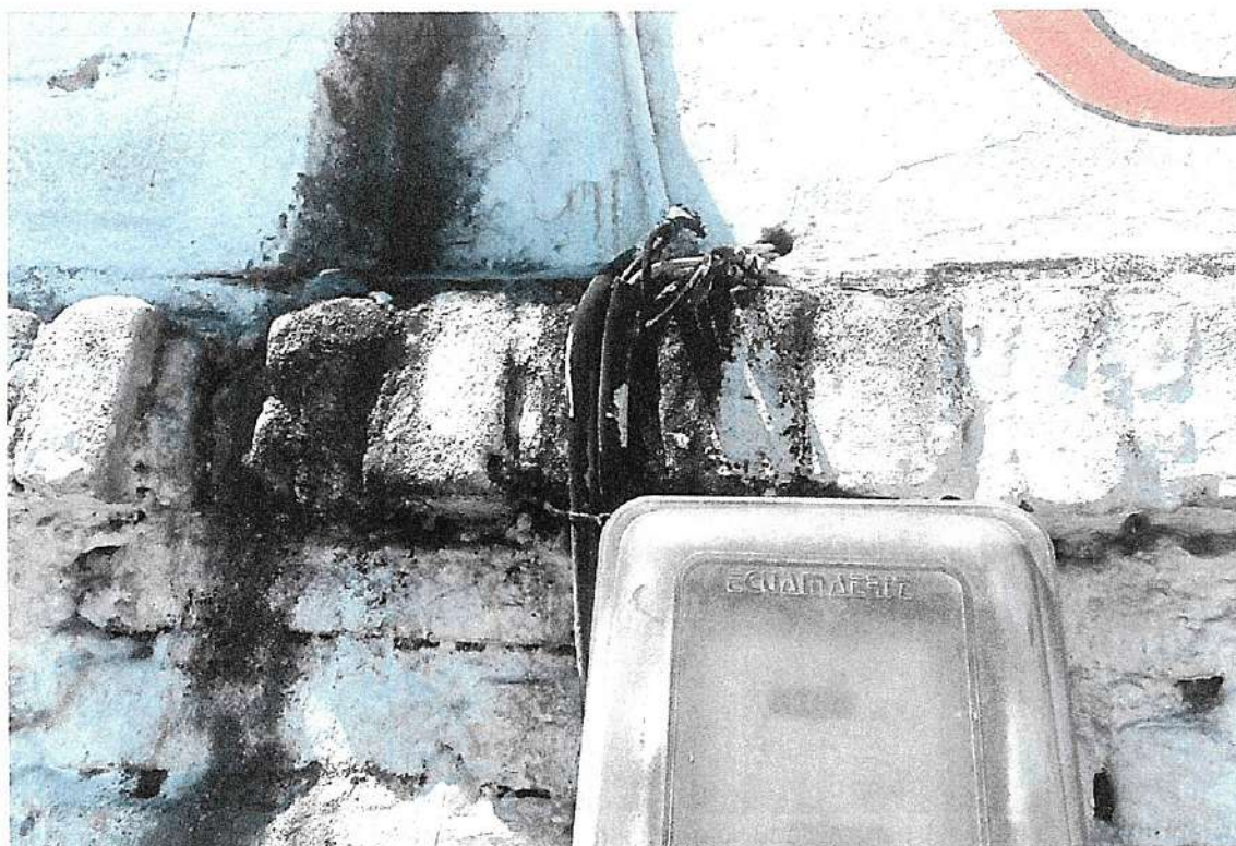
Falta parcial o total de servicios básicos, se evidencia conexiones informales que comparten un medidor.
