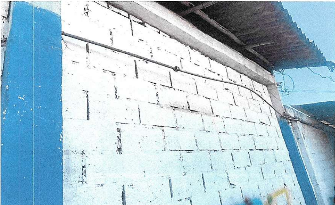
Acceso inadecuado al agua potable; se evidencian conexiones informales expuestas
