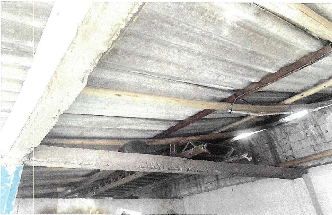
Viviendas con calidad estructural reducida; se evidencias estructuras antiguas con alto nivel de deterioro y material obsoleto.
