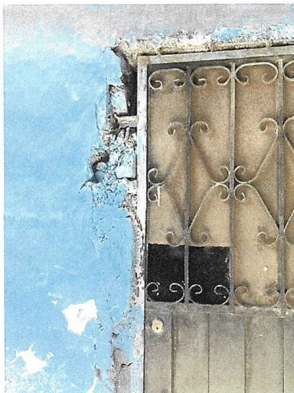
Viviendas con calidad estructural reducida; se evidencias estructuras antiguas con alto nivel de deterioro y material obsoleto
