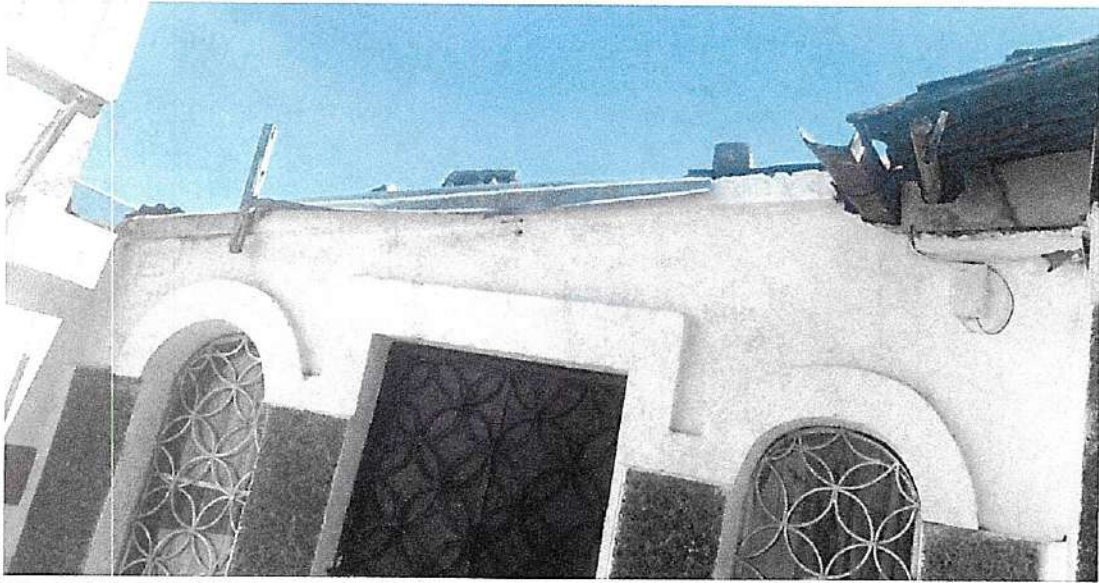
Viviendas con calidad estructural reducida; se evidencias estructuras antiguas con alto nivel de deterioro y material obsoleto
