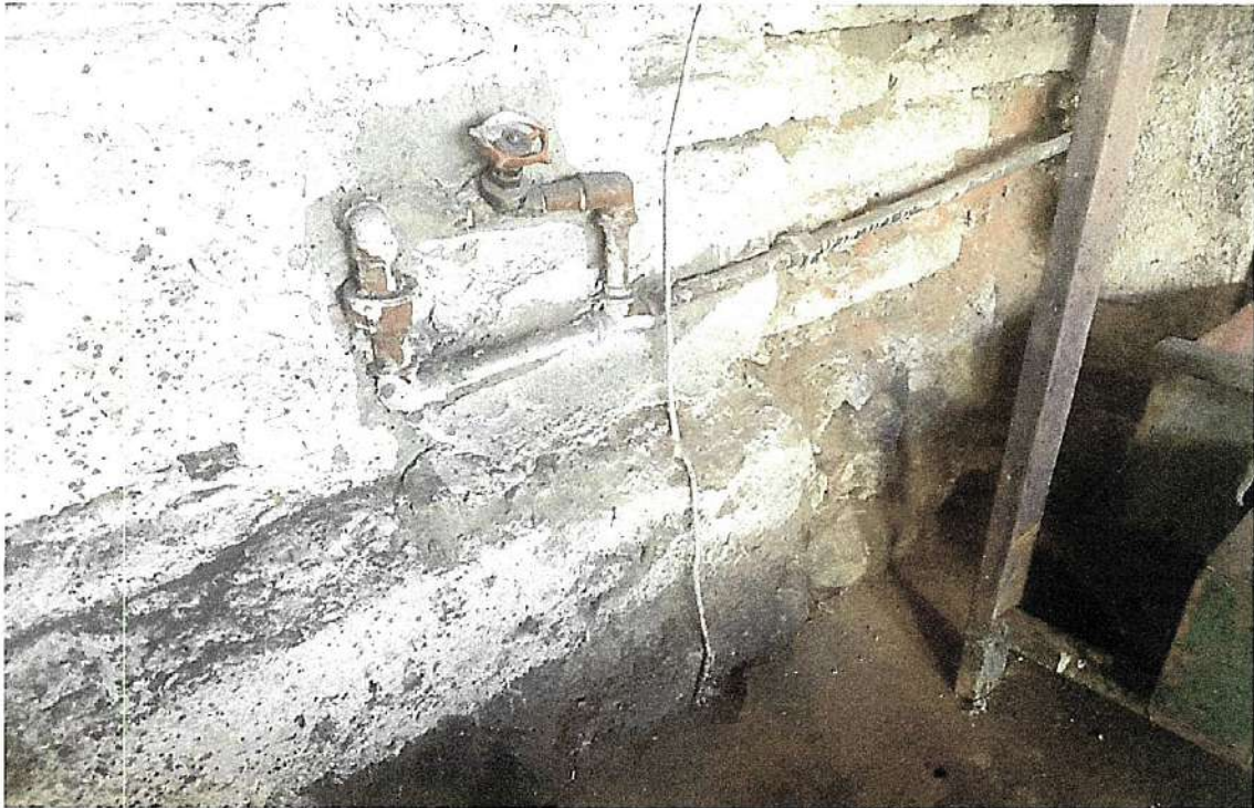
Acceso inadecuado al agua potable; se evidencian conexiones informales expuestas
