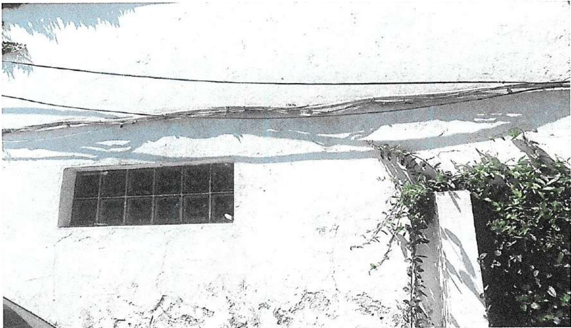
Falta parcial o total de servicios básicos, se evidencia conexiones informales que comparten un medidor.
