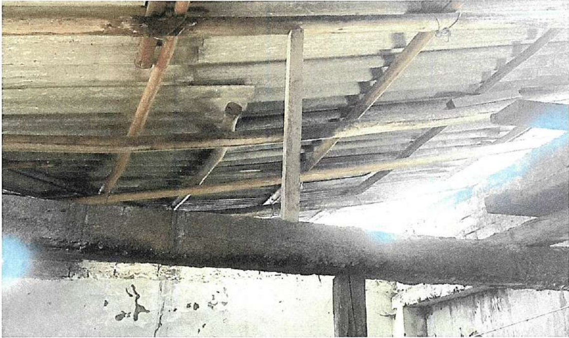
Viviendas con calidad estructural reducida; se evidencias estructuras antiguas con alto nivel de deterioro y material obsoleto.
