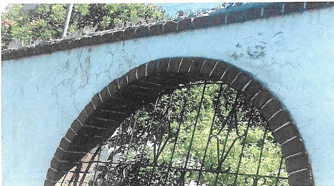
Viviendas con calidad estructural reducida; se evidencias estructuras antiguas con alto nivel de deterioro y material obsoleto
