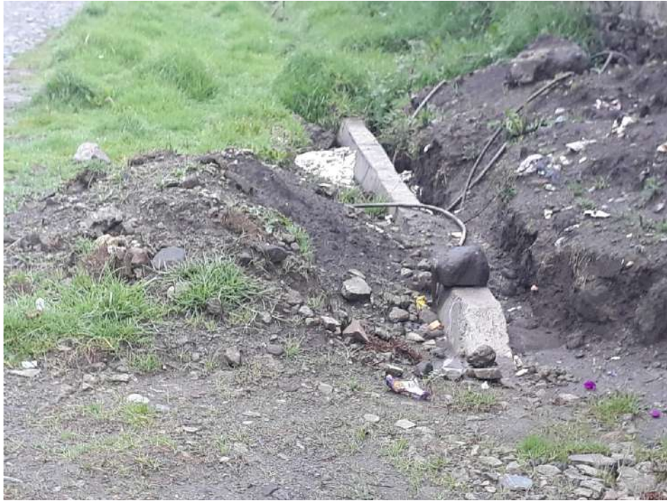
FOTOGRAFÍA 3: Bordillos de la Calle Fernández Heredia.
