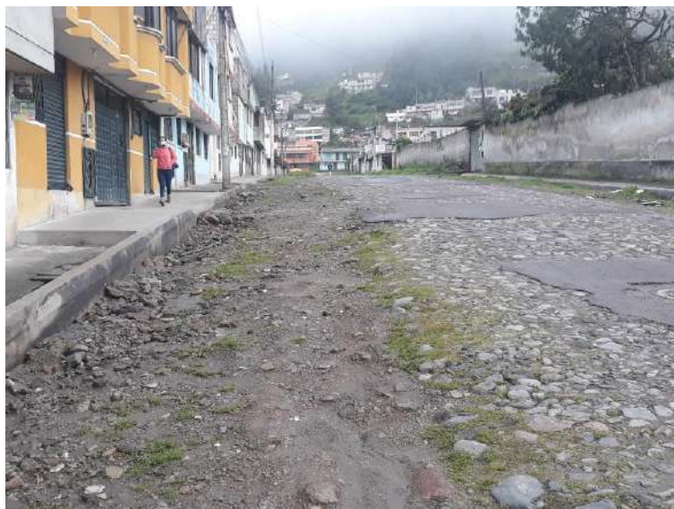
FOTOGRAFÍA 5: Bordillos de la Calle Fernández Heredia.
