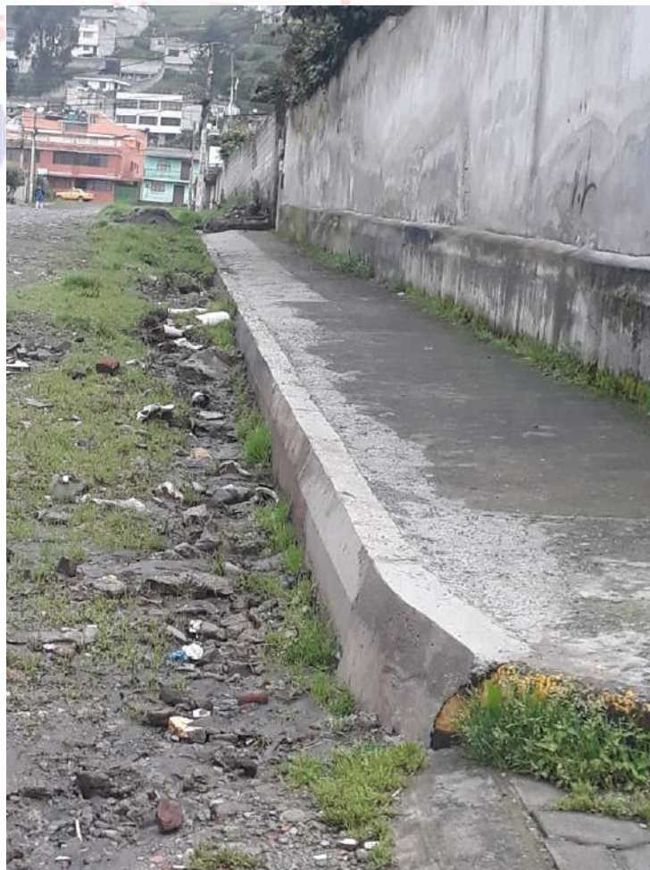
FOTOGRAFÍA 4: Bordillos de la Calle Fernández Heredia.
