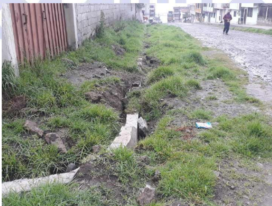
FOTOGRAFÍA 2: Bordillos de la Calle Fernández Heredia.
