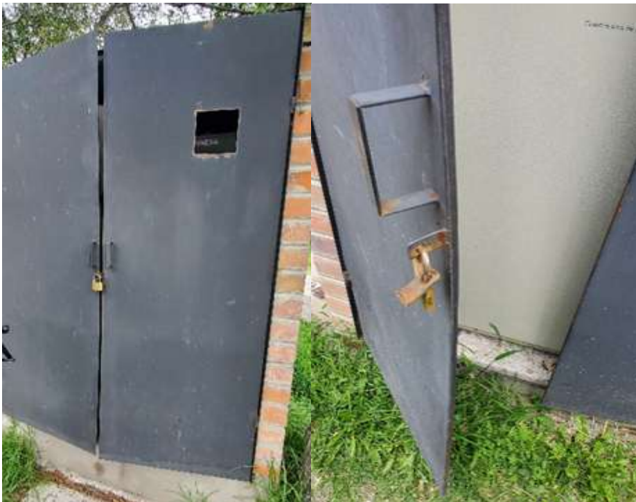
Puertas metálicas en tableros eléctricos deterioradas e inseguras
