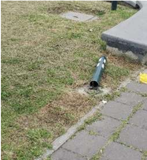
Iluminación alta y baja en mal estado
