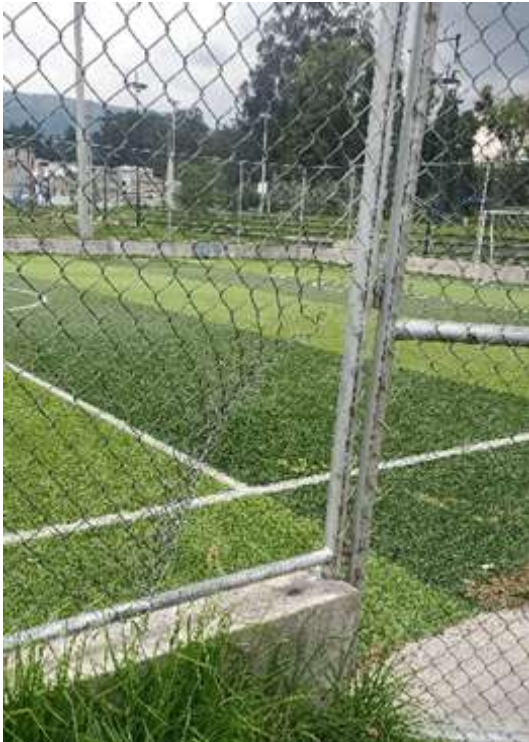
Cerramiento de malla en cancha de césped sintético en mal estado
