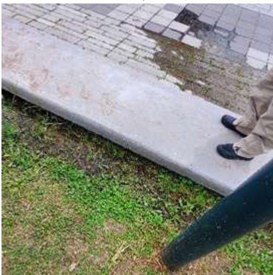
Fuga en el sistema de agua potable
