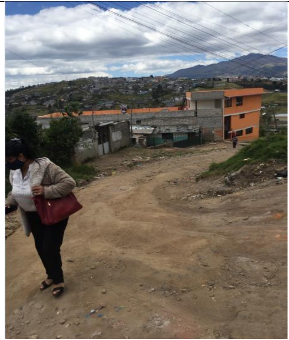
Observaciones: Vía en mal estado que dificulta la circulación vehicular y peatonal
