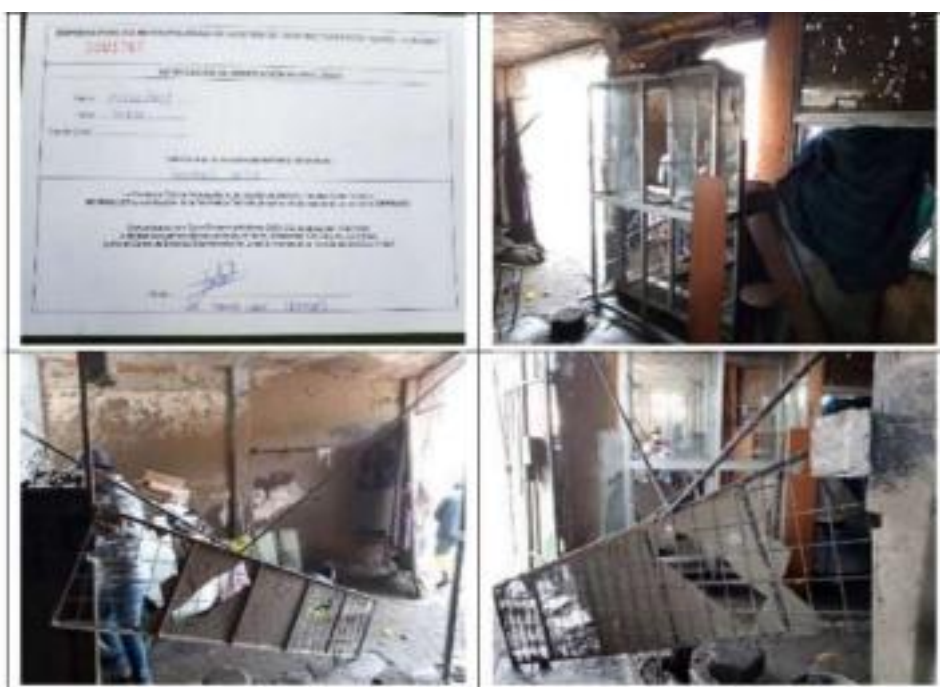
Ficha No. 1767 (Distribuidora de Licor) Corresponde a un inmueble de 2 plantas, con uso principal de vivienda que, junto al área de estacionamiento, se habilitó un área para el almacenamiento y venta de licores. Este local presenta daños en el portón de acceso (puerta enrollable tipo lanfor) y el colapso de una de las paredes laterales internas del local, con otros daños menores en ventanearía y recubrimiento de paredes. El propietario de la actividad económica informó que sufrió la pérdida total de su mercancía.
