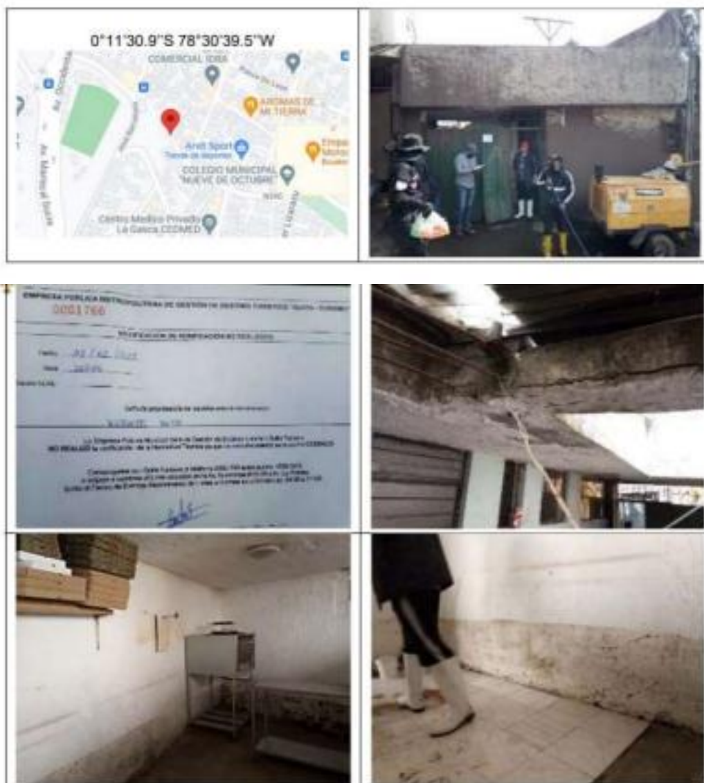
Ficha No. 1766 (Pizzería) Corresponde a un inmueble de 1 sola planta con terraza accesible, que en la parte frontal se había habilitado un área menor para el desarrollo comercial de preparación de pizzas. El inmueble presenta una fisura en una viga externa al área habitable y otros daños menores en recubrimiento de paredes y pisos. El propietario de la actividad económica informó que, adicionalmente, había sufrido afectaciones por pérdida y daño en mobiliario (cocina y mesas) y mercancía (materia prima para elaboración de pizzas).
