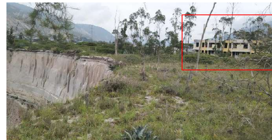
Foto No. 4: Inestabilidad de talud, erosión eólica, en conjunto la Arbolada..
