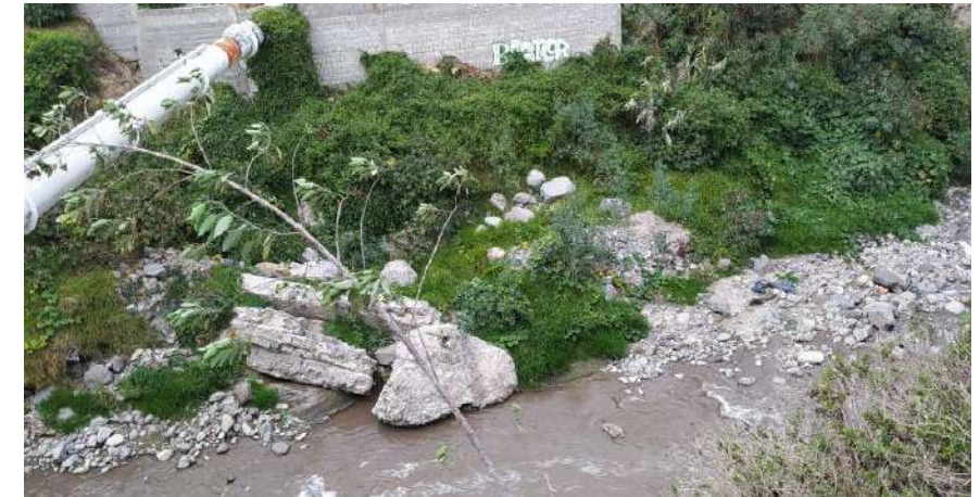
Foto No. 4: Muros colapsados en cauce.
