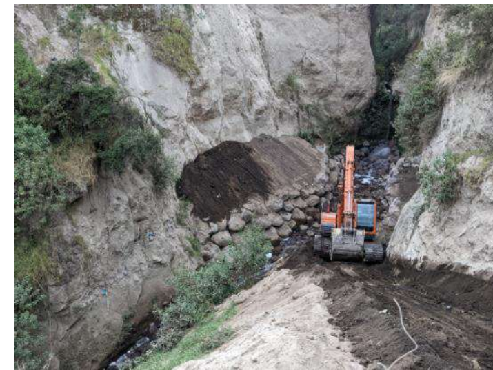
Foto No. 4: Colocación de piedra en márgenes en el sector Puertas del Sol- Quebrada Carretas, julio 2021.
