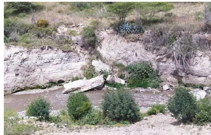
Foto No. 2 Elementos de muro colapsados en cauce.
