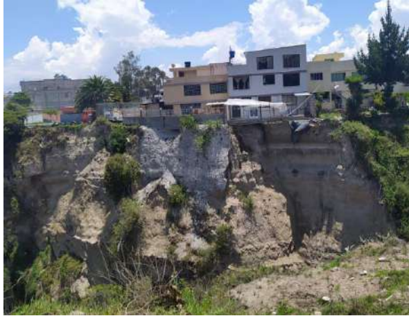
Foto No. 1: Inestabilidad de taludes, afectación a viviendas.
