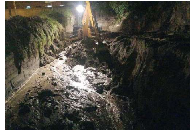
Foto No. 4: Zona de inundación,
