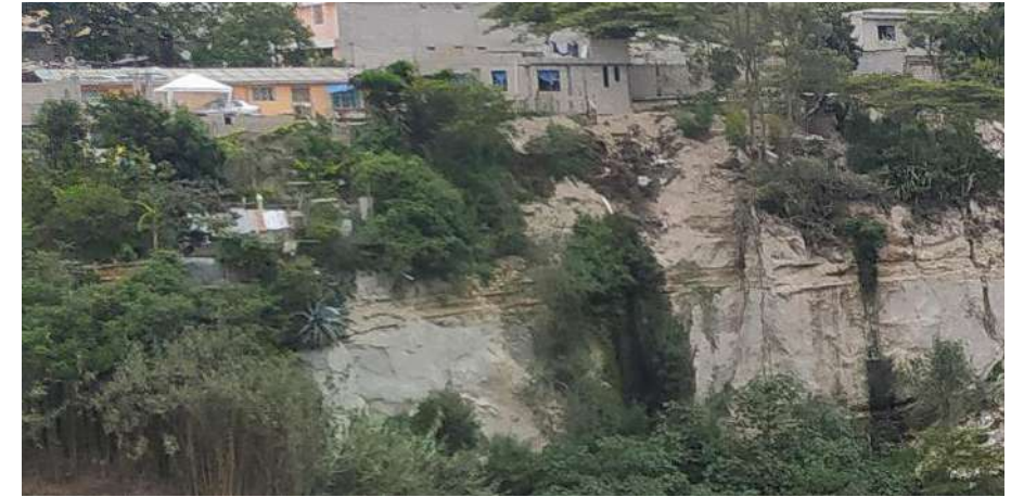
Foto No. 3: Viviendas al borde del talud.
