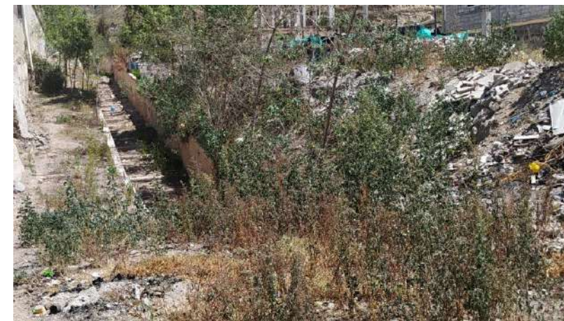
Foto No. 4: Botadero de escombros sobre estructura hidráulica.
