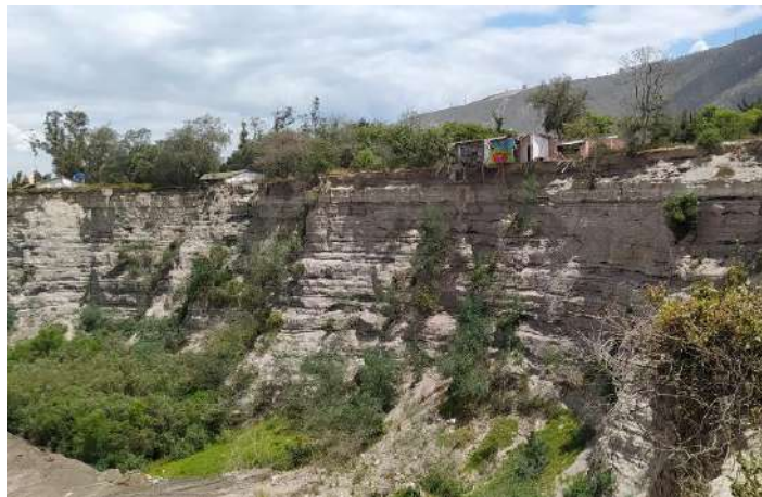
Foto No. 1: Inestabilidad de taludes-relleno técnico de EPMAPS
