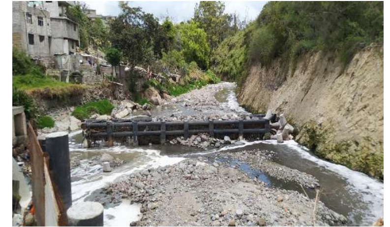
Foto No. 3: Estructuras hidráulicas EPMAPS azolvadas.
