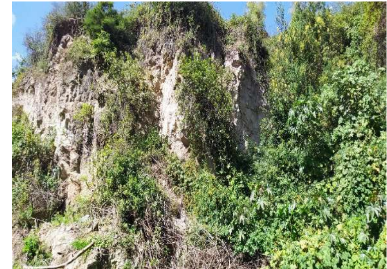
Foto No. 4: Árboles que generan inestabilidad talud debido a las raíces y podrían caer al cauce.
