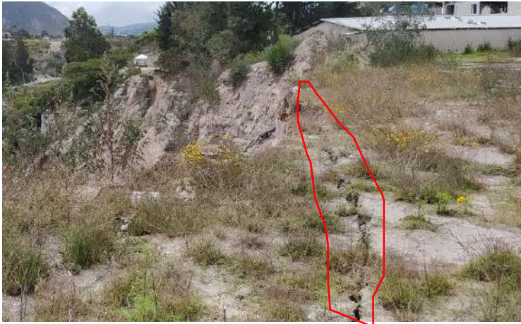
Foto No. 1: Agrietamiento en superficie cancha
