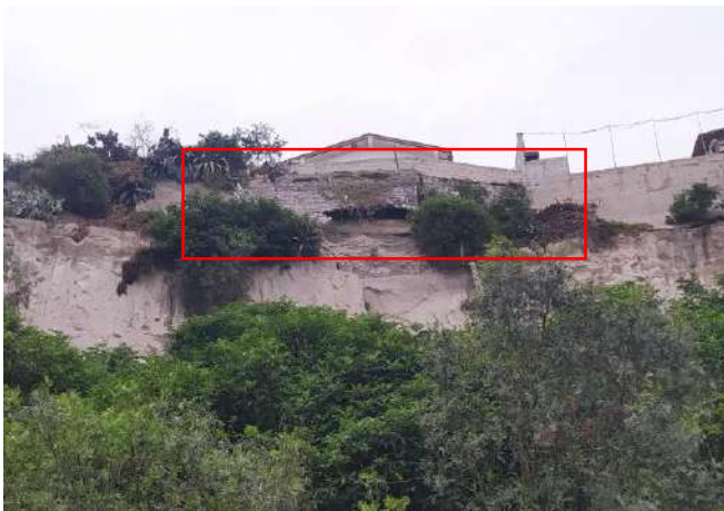
Foto No. 2 Muro sin base de cimentación.
