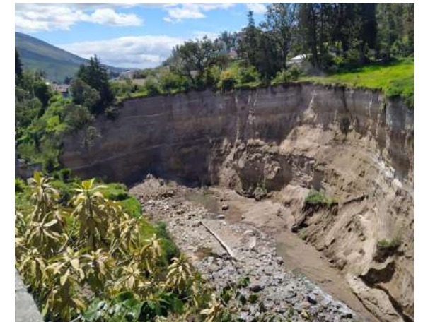
Foto No. 4: Inestabilidad de taludes-Márgenes Casa Hacienda)
