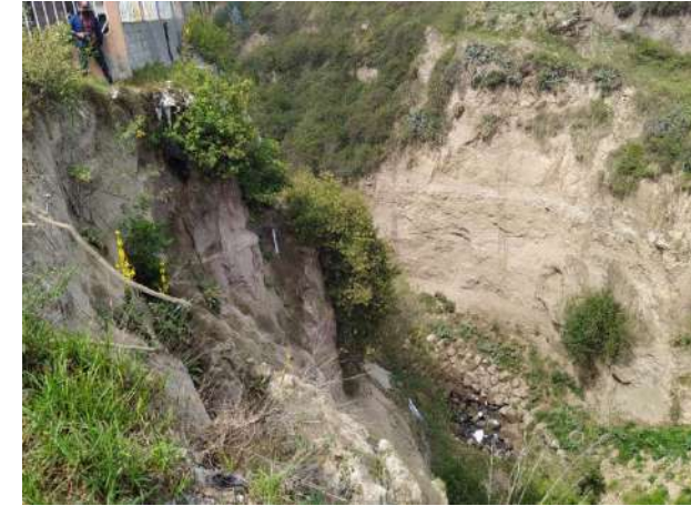
Foto No. 3: Inestabilidad en taludes, afectación a infraestructura pública
