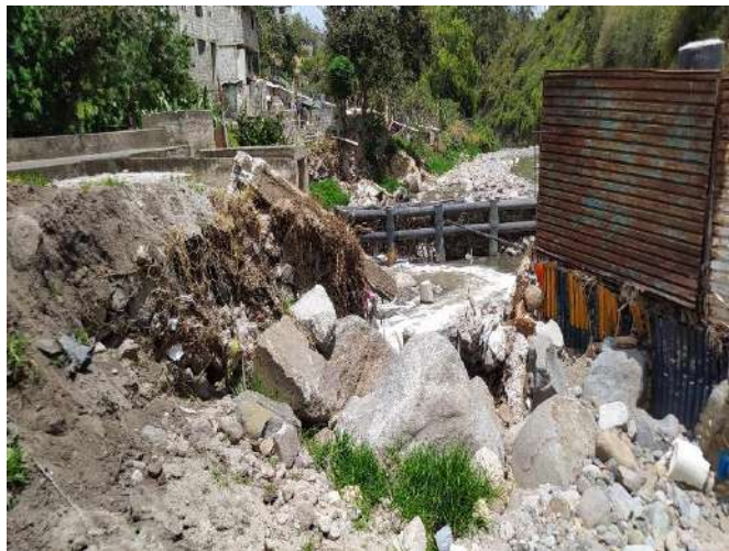
Foto No. 2: Elementos estructurales EPMAPS de muros colapsados en cauce.
