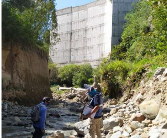
Foto No. 1: Viviendas adosadas al muro Pfizer y ubicadas a borde del talud.
