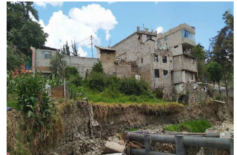
Foto No. 4: Viviendas en margen izquierda en zonas considerados como de inundación.
