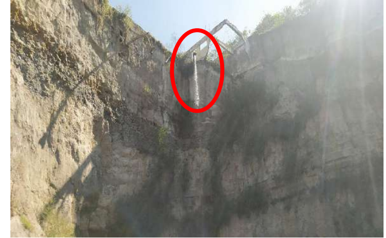
Foto No. 3: Colector de aguas servidas de conjunto directas al cauce
