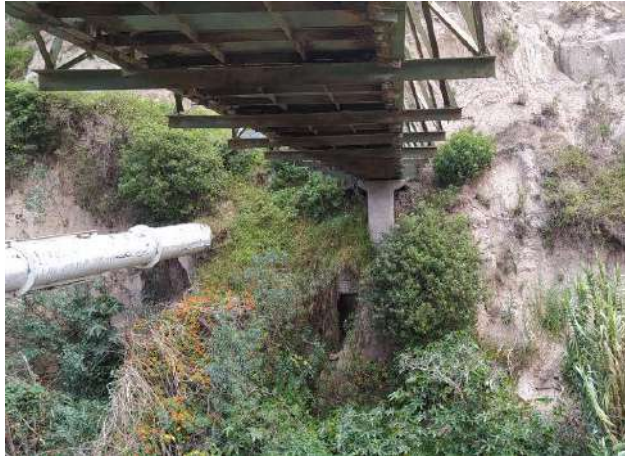
Foto No. 1: Base de puente peatonal expuesta, debido a inestabilidad de talud margen izq.
