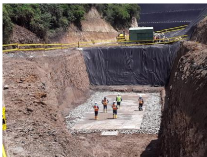
Foto 1: Piscina de lixiviados
