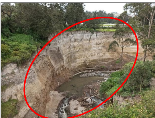
Imagen No. 3 Desprendimientos del talud
