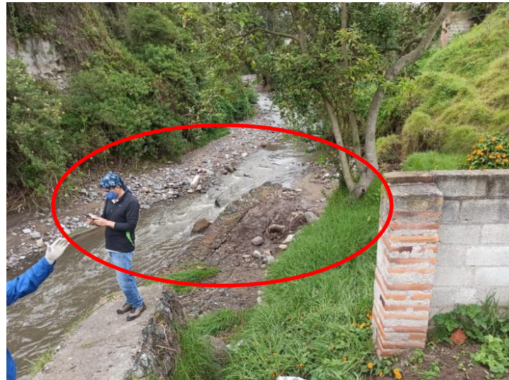
Imagen No. 8 Sitio a reconstruir los muros de gaviones (afectados por la crecida)
