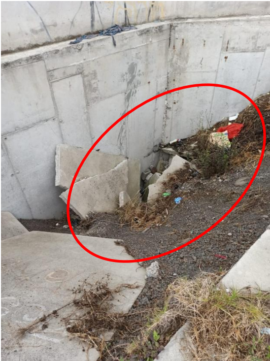
Imagen No. 1 Vista exterior del muro y la pérdida del material de relleno
