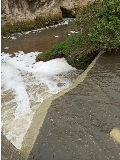
Imagen No. 6 Descarga colector
