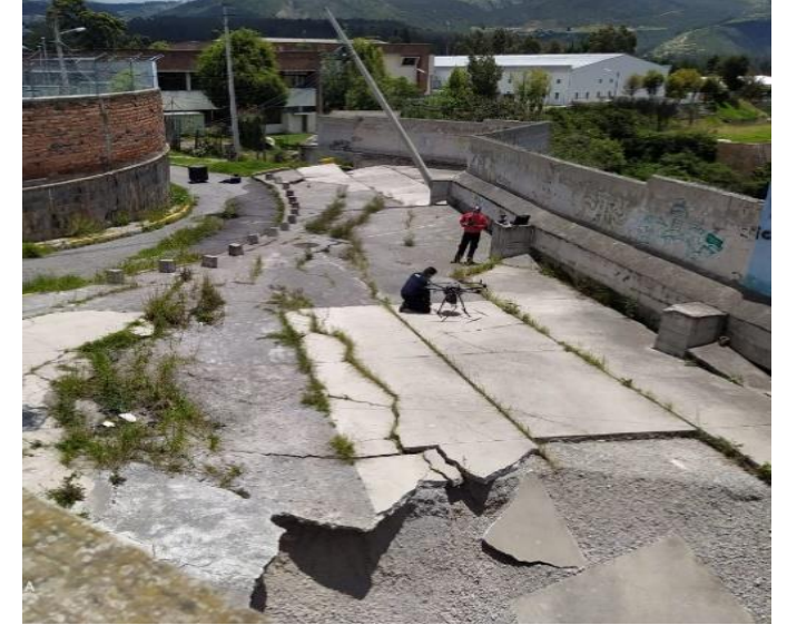
Foto No. 3: Asentamiento de la mesa de la vía y fuga de material de relleno.
