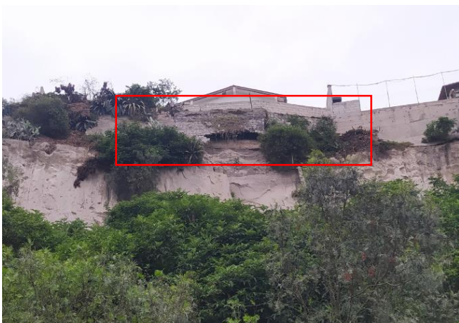
Foto No. 2 Muro sin base de cimentación.
