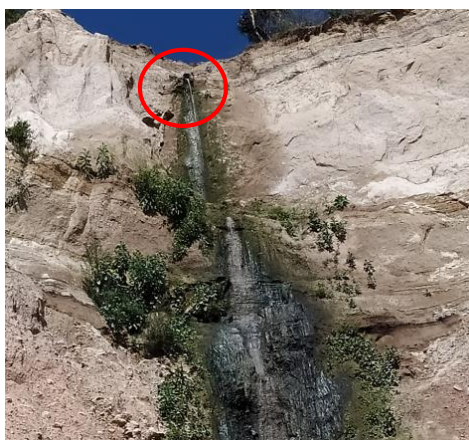
Foto No. 2 descargas informales al talud
