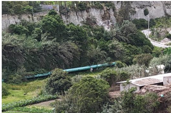
Foto No. 2 Tubería sub aérea de aguas servidas ( se encuentra en zona de inundación)
