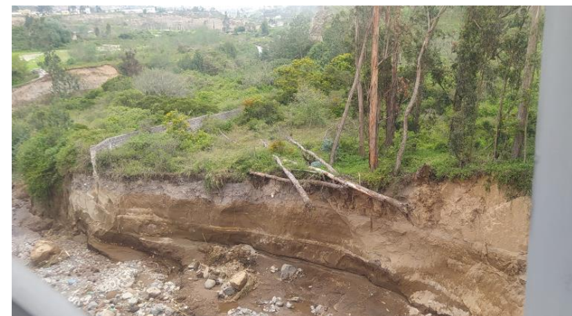
Foto No. 4: Árboles al borde superior de talud., por caer generan inestabilidad talud.
