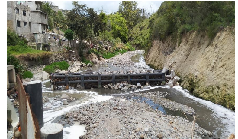
Foto No. 3: Estructuras hidráulicas asolvadas.
