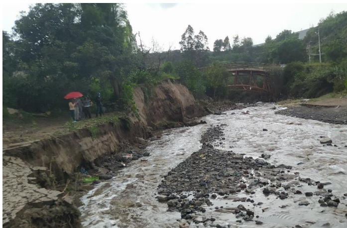
Foto No. 2 Zona de inundación, margen izquierda
