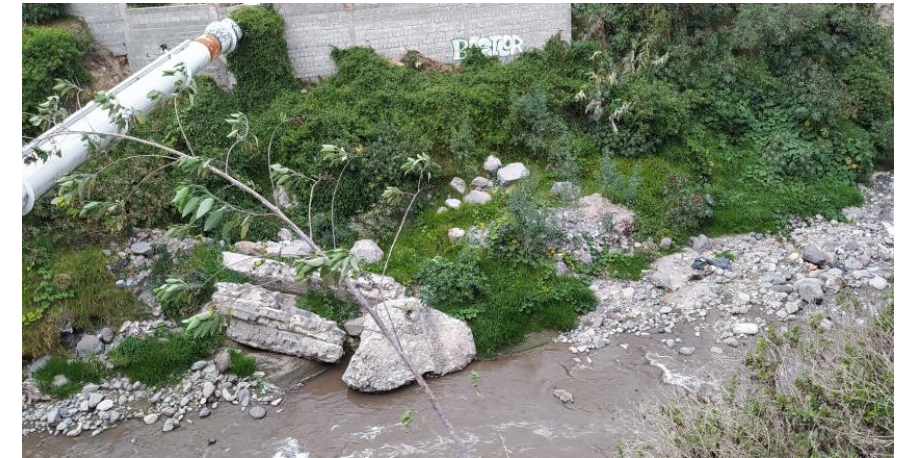
Foto No. 4: Muros colapsados en cauce.
