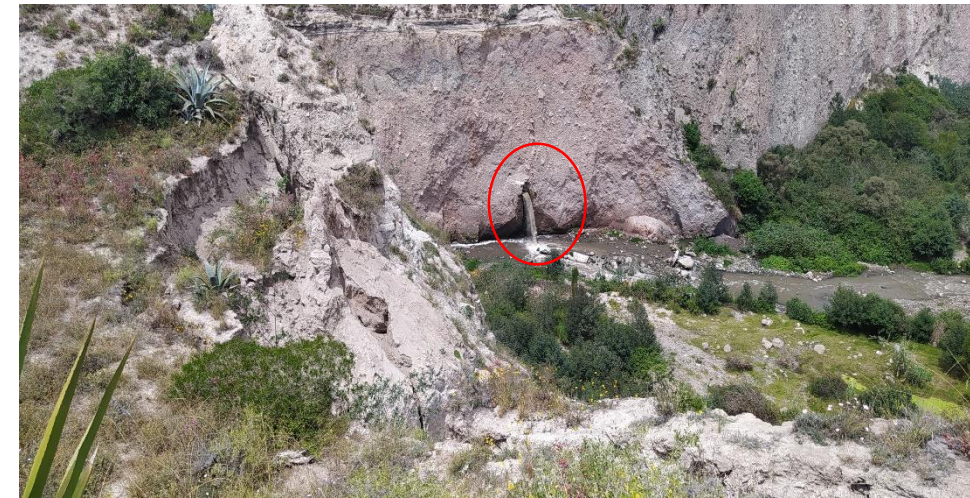
Foto No. 4: descargas directas al cauce
