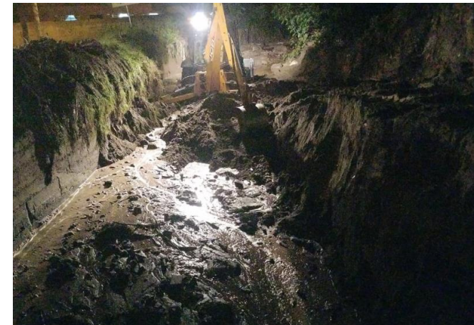
Foto No. 4: Zona de inundación,
