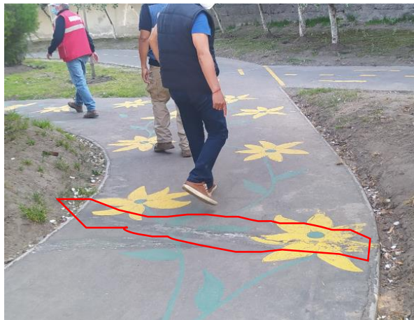
Foto No. 2: Fisura en superficie del área recreativa
