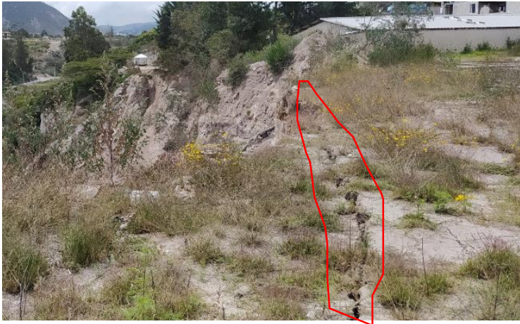
Foto No. 1: Agrietamiento en superficie cancha
