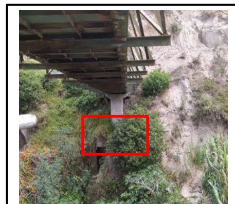
Cimentación de puente parcialmente sin base.
